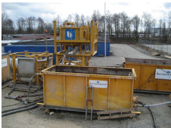
Abbildung D.9: Container für Bentonitsuspension (vorne) und Restpolymerlösungen (hinten rechts)
