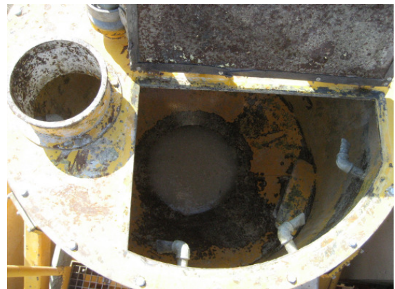
Abbildung D.8: Blick in die Mischanlage
