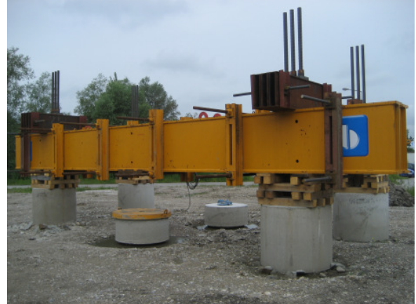
Abbildung D.48: Belastungstraverse für Pfahlprobelbelastungen
