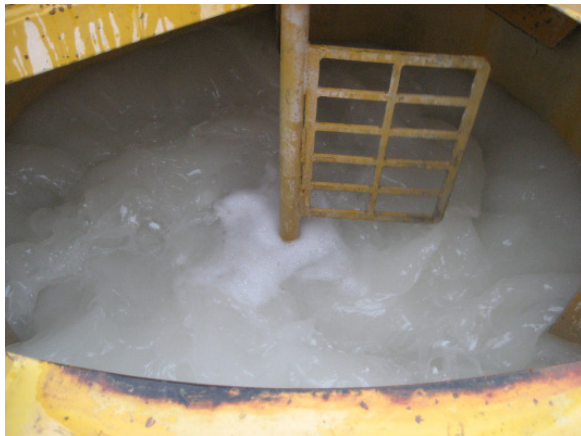
Abbildung D.23: Rührwerk im Hochbehälter
