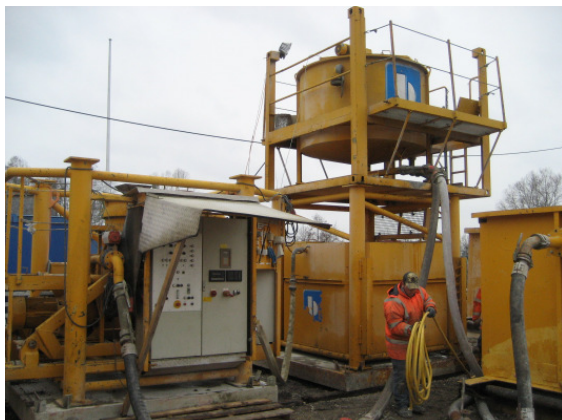
Abbildung D.7: Mischanlage mit Hochbehälter
