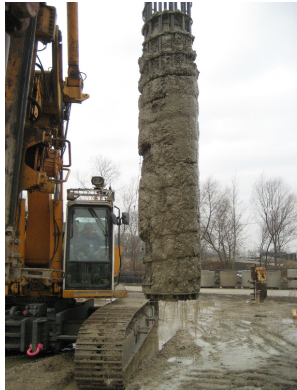
Abbildung D.38: Bewehrungskorb mit vorzeitig angesteiftem Beton (Pfahl P 1)
