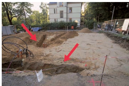
Abb. 1: Blick auf das Baugrundstück mit der Auffüllung aus Grobkies sowie den nachträglichen, umfangreichen Aufgrabungen für Rohre und Kabel
