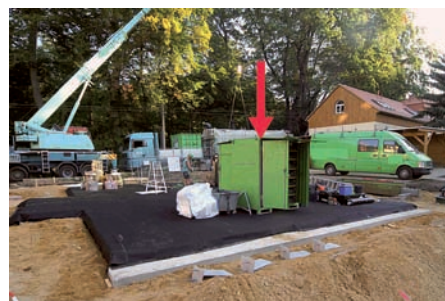
Abb. 08: Zu Beginn der Montage des Fertighauses wurde eine vorkonfektionierte EPDM-Bahn lose über die Bodenplatte als Feuchteabdichtung verlegt. Werkzeuge, Arbeitscontainer und Baustoffe wurden ohne Schutzlage darauf abgestellt
