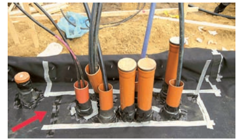
Abb. 3: Im Bereich der Rohrdurchdringungen wurde die EPDM-Bahn herausgeschnitten, um selbige über Rohre fädeln zu können. Statt Schweißnähten wurden Klebebänder an den Schnittstellen aufgebracht. Die Abstände zwischen den Rohren sind viel zu gering, um die Durchdringungen an die Abdichtungsbahn mit Einbauteilen fachgerecht anschließen zu können.
