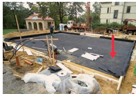
Abb. 2: Blick auf die vorgefertigt verschweißten Bahnen der Radonabdichtung / wellige EPDM-Bahnen ragen über die Randabschalungen der Bodenplatte
