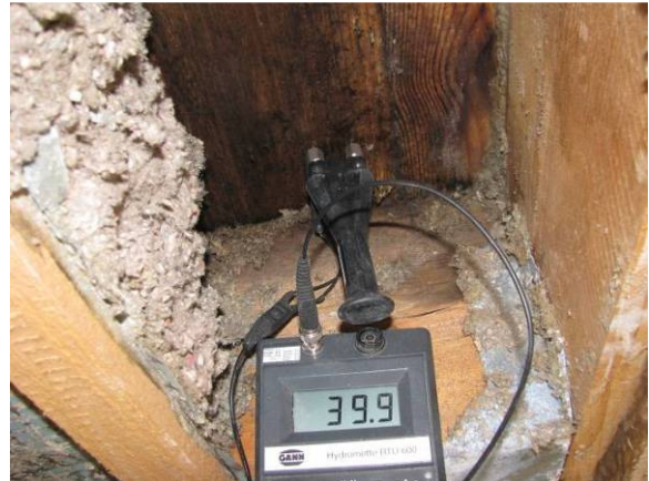
schadhafter Bereich, komprimierte Dämmung
