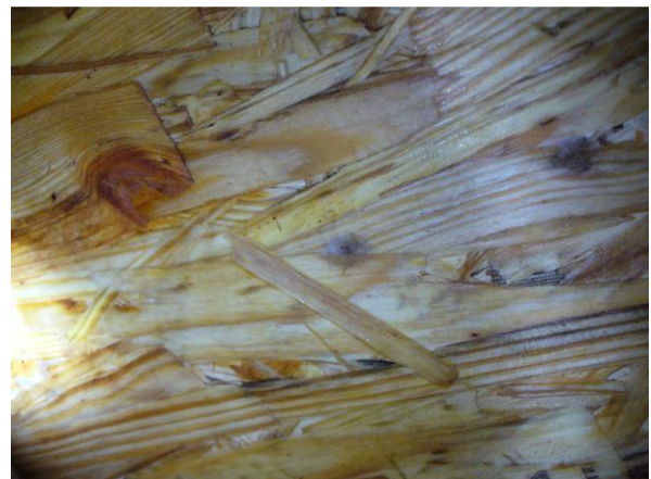
Abb. 34 Oberflächenkondensat und Schimmelbefall im Gefach, Variante 4.2
