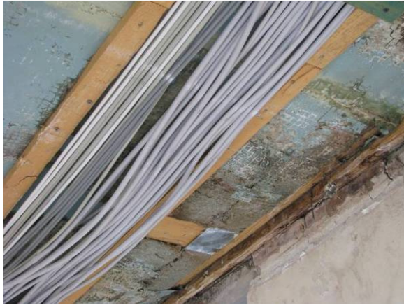
Fehlstelle infolge Feuchteschaden
