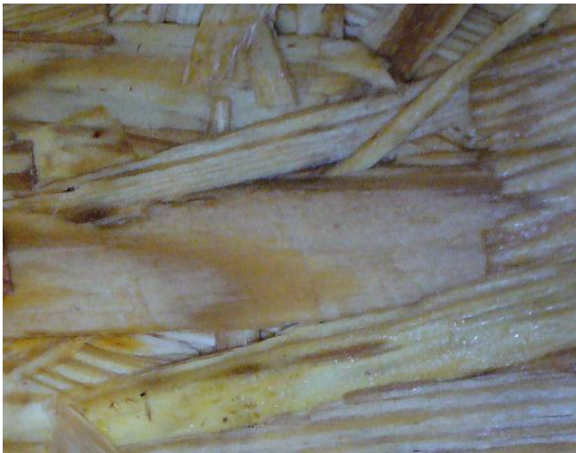
Abb. 28 Oberflächenkondensat an der OSB-Platte, Var. 2.1
