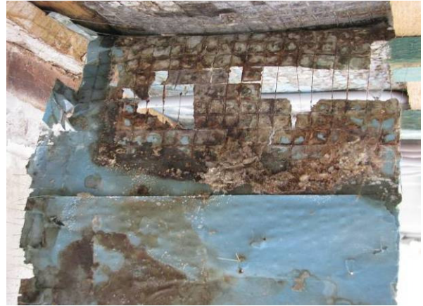
Grad der Zerstörung der Dampfbremse als Folge einer Abdichtungs-Leckage
