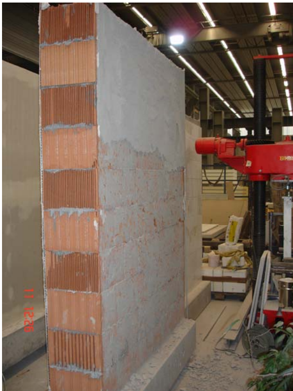
Abbildung 26: Zerstörter Zementputz auf Ziegelwand nach Abnahme des Fliesenbelags
