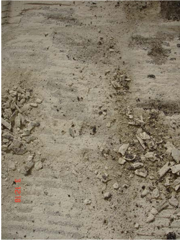
Abbildung 30: Gussasphaltestrich nach erstem Ablösen des Fliesenbelags
