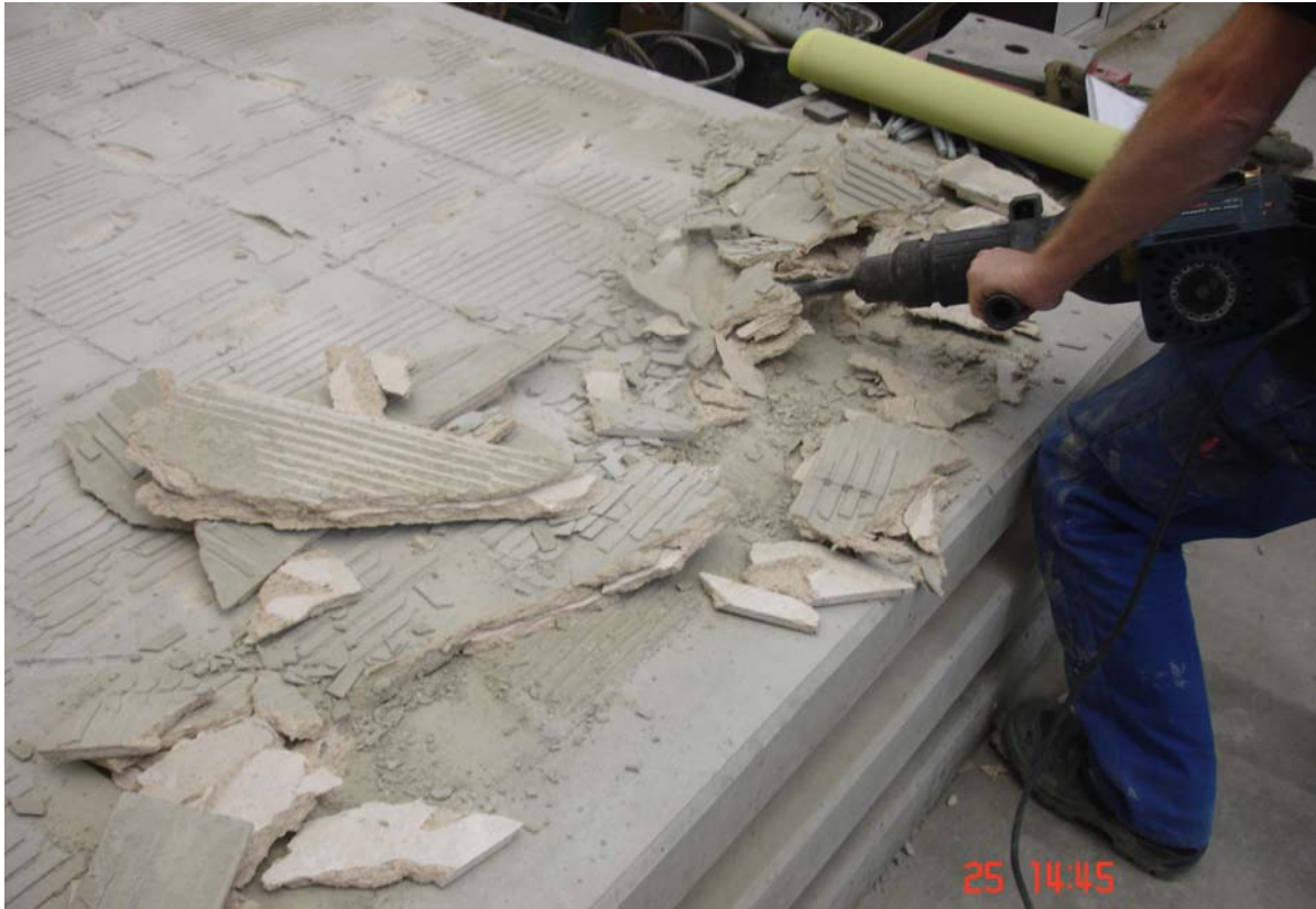
Abbildung 29: Demontage des zerstörten Trockenestrichs nach Abnahme des Fliesenbelags
