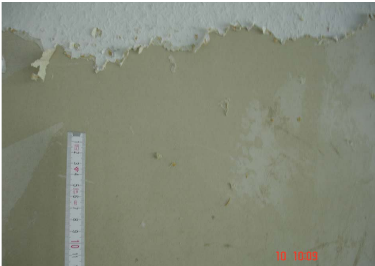
Abbildung 61: Ablösen von überstrichener Raufasertapete auf Gipskarton in einer realen Baumaßnahme
