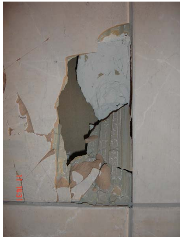
Abbildung 27: Zerstörte Gipskartonwand bei Demontage des Fliesenbelags
