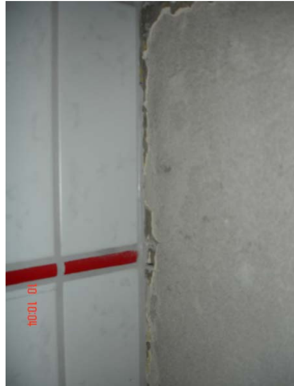
Abbildung 63: Eckbereich der Badfliesen nach dem Ablösen an einer Wand
