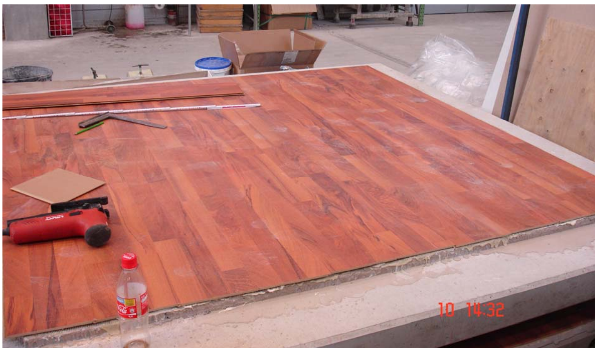
Abbildung 12: Geklebtes Laminat auf Zementestrich
