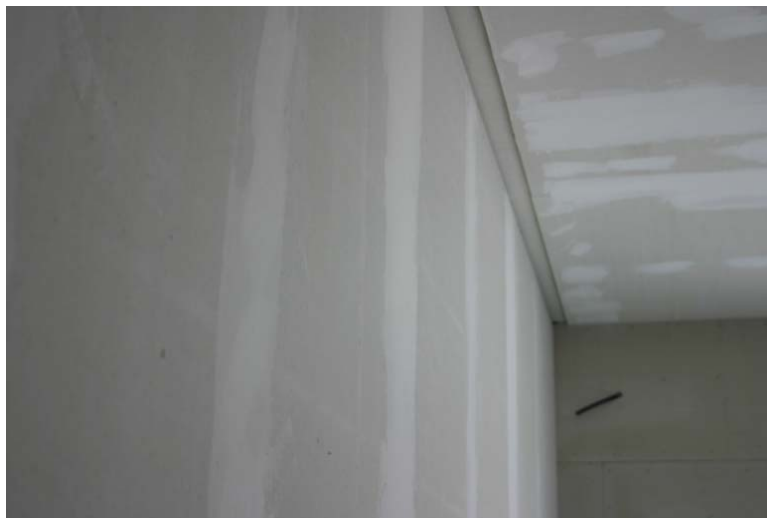
Abbildung 57: Etwa 3 cm breite Fuge im Anschluss Decke - Wand
