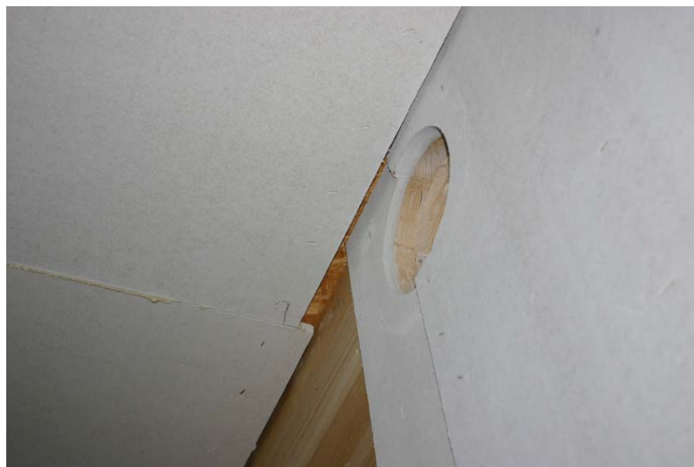
Abbildung 59: Fuge und unplanmäßiger Fugenversatz im Anschluss Decke - Wand
