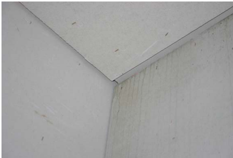
Abbildung 58: Etwa 2 cm bereite Fugen im Anschluss Decke - Wand
