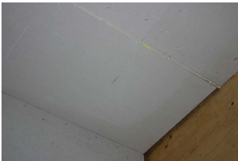
Abbildung 60: Etwa 3 cm breite Fuge im Anschluss Decke - Wand
