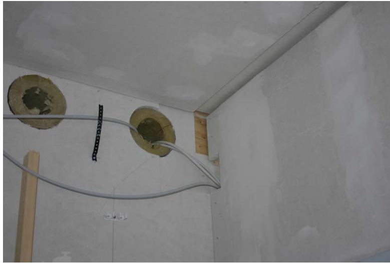
Abbildung 61: Etwa 5 cm und 2 cm breite Fugen im Anschluss Decke - Wand
