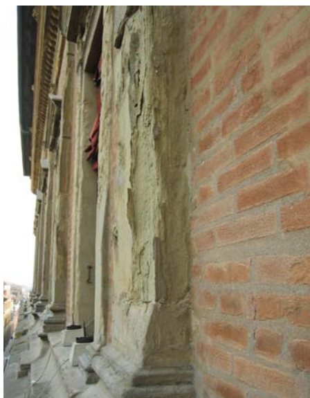
Abb. 28: Palazzo Malvezzi, bewitterte Nordwestfassade, 3. Obergeschoß, schwer geschädigte Fenstereinfassungen aus Varignana Sandstein mit Mehrfachschalenbildung, Kornbindungsverlust und Absanden.
