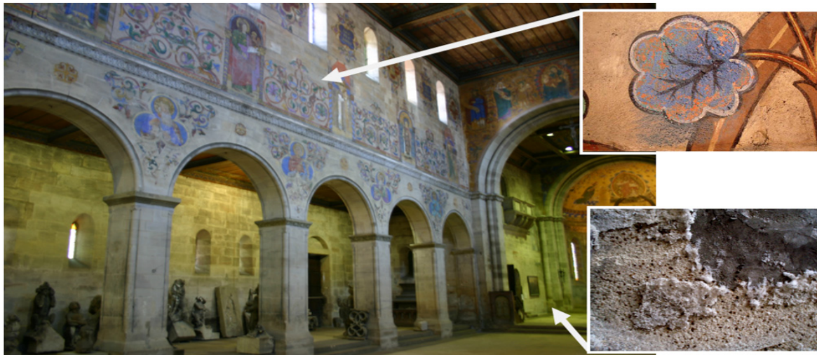
Abb. 23: Schadensbilder in der Johanniskirche: Schäden an den Wandmalereien und Salzausblühungen im Sockelbereich.
