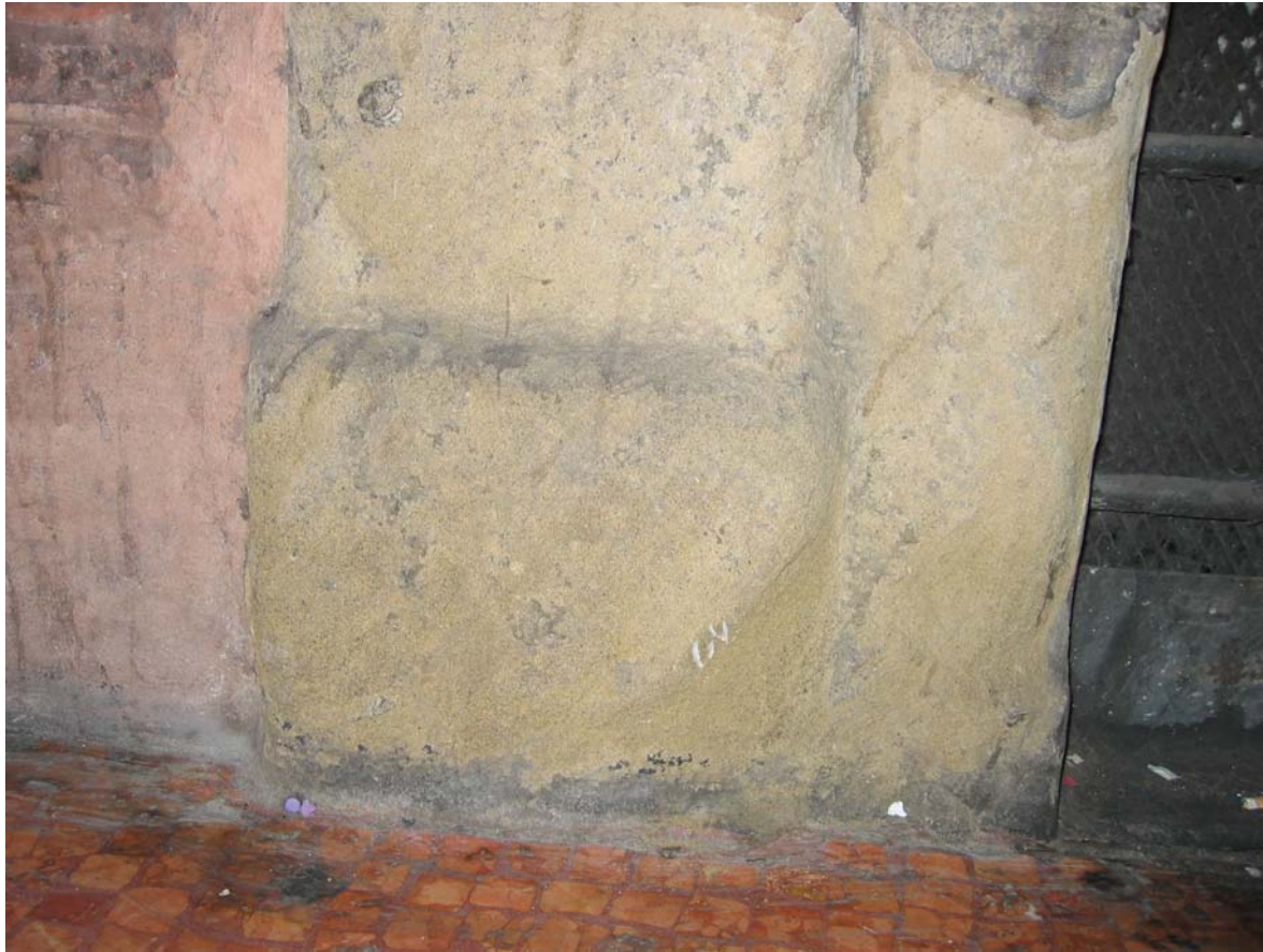
Abb. 29: Sandsteineinfassung in der Sockelzone mit Resten von Schmutzkruste, Rückwitterung durch Absanden und hygroskopische Feuchtflecken.
