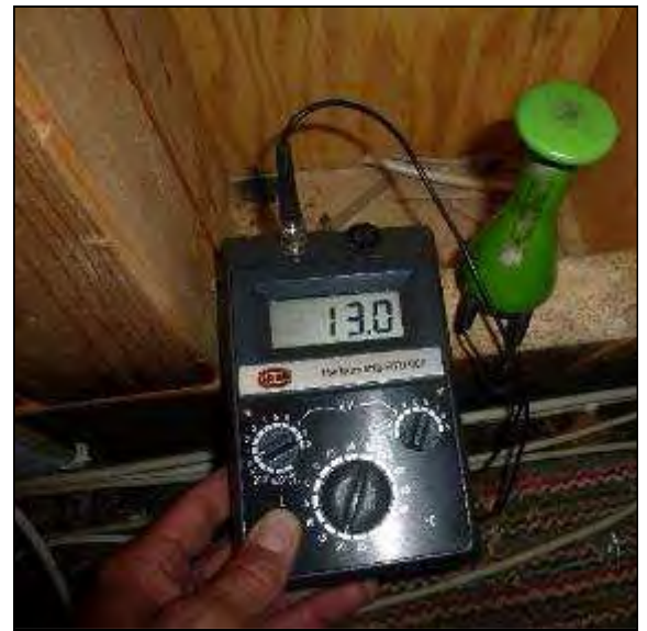
Abb. 58: Geringe Holzfeuchte im Bereich des Schwellenholzes
