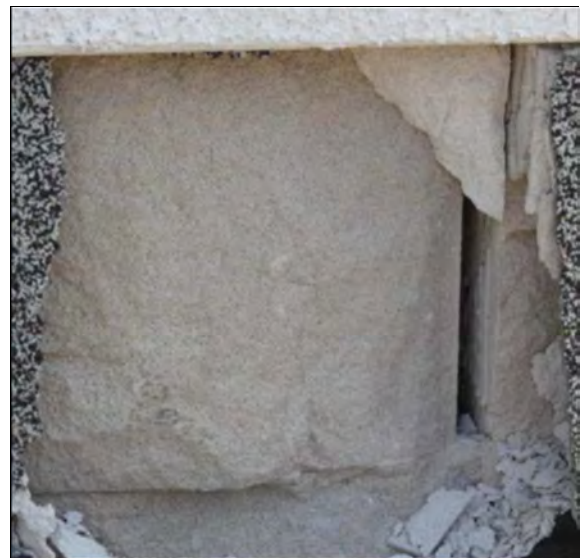
Abb. 14: Offene Stoßfuge des Porenbetonmauerwerks
