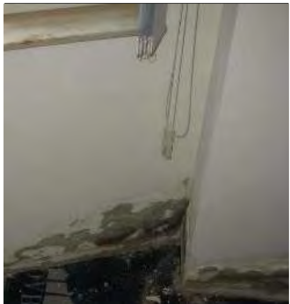
Abb. 20: Wasserschäden in der Sockelzone im Gebäudeinnern.
