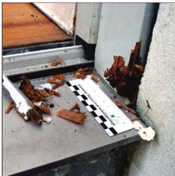
Abb. 41: Deutlich geschädigter Holzpfosten der Schiebetüranlage
