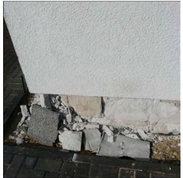
Abb. 12: Schollenförmige Abplatzungen im Sockelbereich
