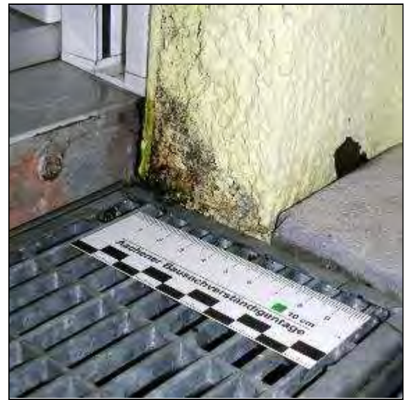
Abb. 46: Durchfeuchtungsschäden im Bereich der Türschwelle
