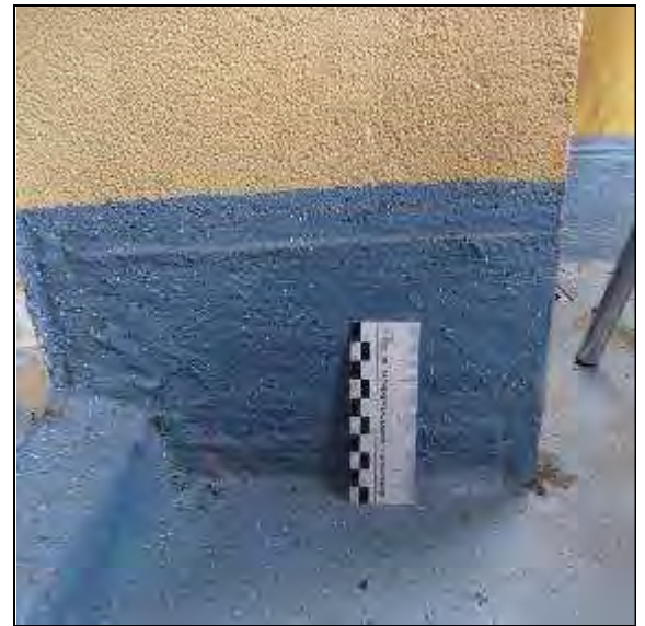
Abb. 82: Die Aufkantungshöhe der Beschichtung beträgt gut 15 cm
