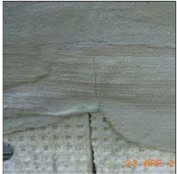
Abb. 18: Die Stoßfugen zeichnen sich als Rissbildungen ab.
