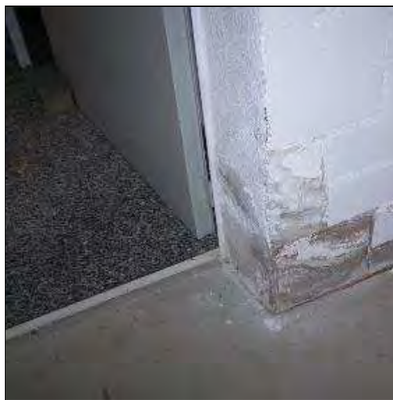
Abb. 48: Typisches Schadensfoto im Bereich der Kellerwände
