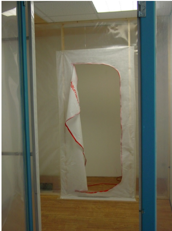
Bild 4: Blick durch den Vorraum auf Abschottung mit Reißverschluss.
