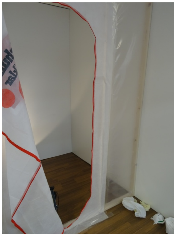
Bild 3: Abschottung aus Kunststofffaservlies mit geöffnetem Reißverschluss.
