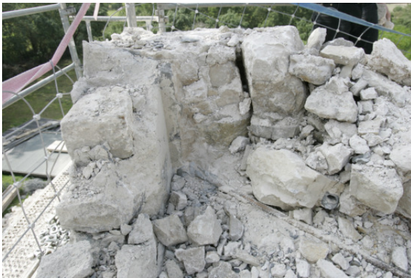
Bild 5 Zerstörtes Mauerwerksgefüge des Kirchturms der Kirche in Eilenstedt
