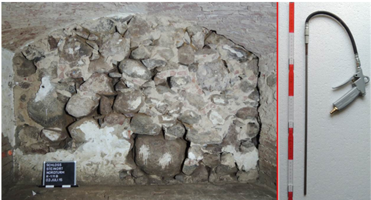
Bild 98 links die Kellerwand aus Feldstein in Lehm versetzt mit ausgewaschenen Fugen, rechts die Ausblaspistole mit Gummischlauch und Lanze
