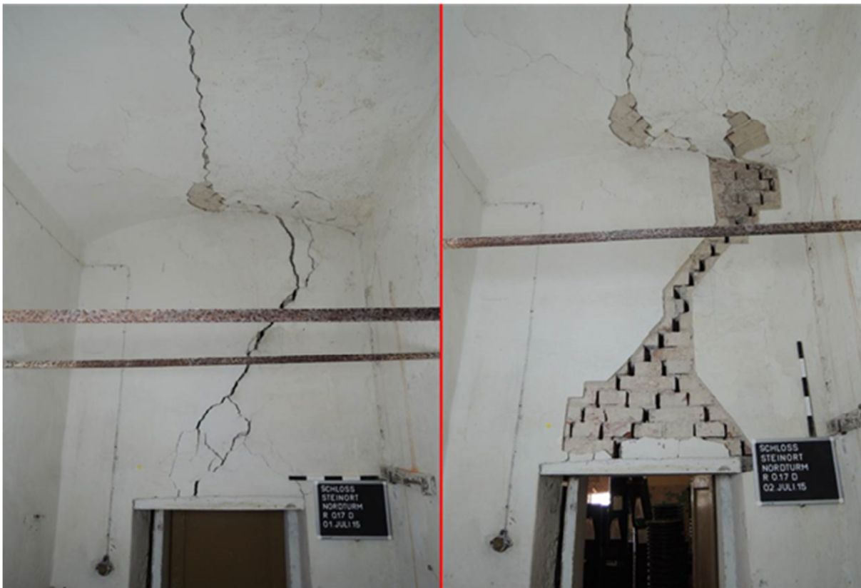
Bild 101 Links die Wand mit Riss in Originalzustand, rechts nach dem Öffnen des
