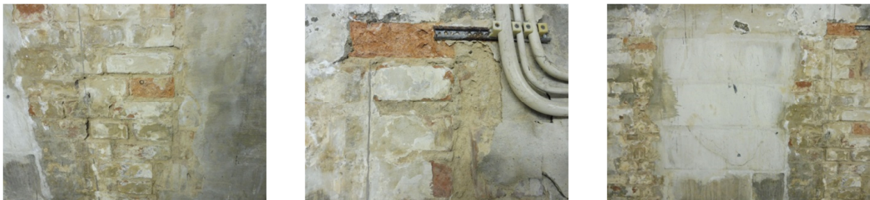
Abbildung 8 Zu Abbildung 7 zugehörige Dokumentation zur Schadenskartierung
