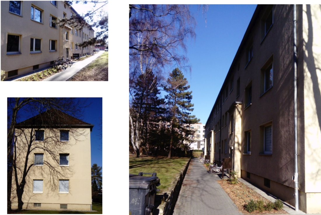
Abbildung 50 Außenaufnahmen des Gebäudes für die dritte Eruerung der Thermographie als zerstörungsfreie Bauwerksuntersuchung
