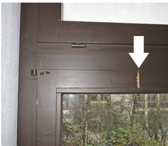
Bild 6 Jährelanges Anschlagen an die Leibungskante hat Spuren am unteren Flügelrahmen hinterlassen (Pfeil); die Bänder haben hier allerdings die wiederholten Belastungen bislang gut überstanden
