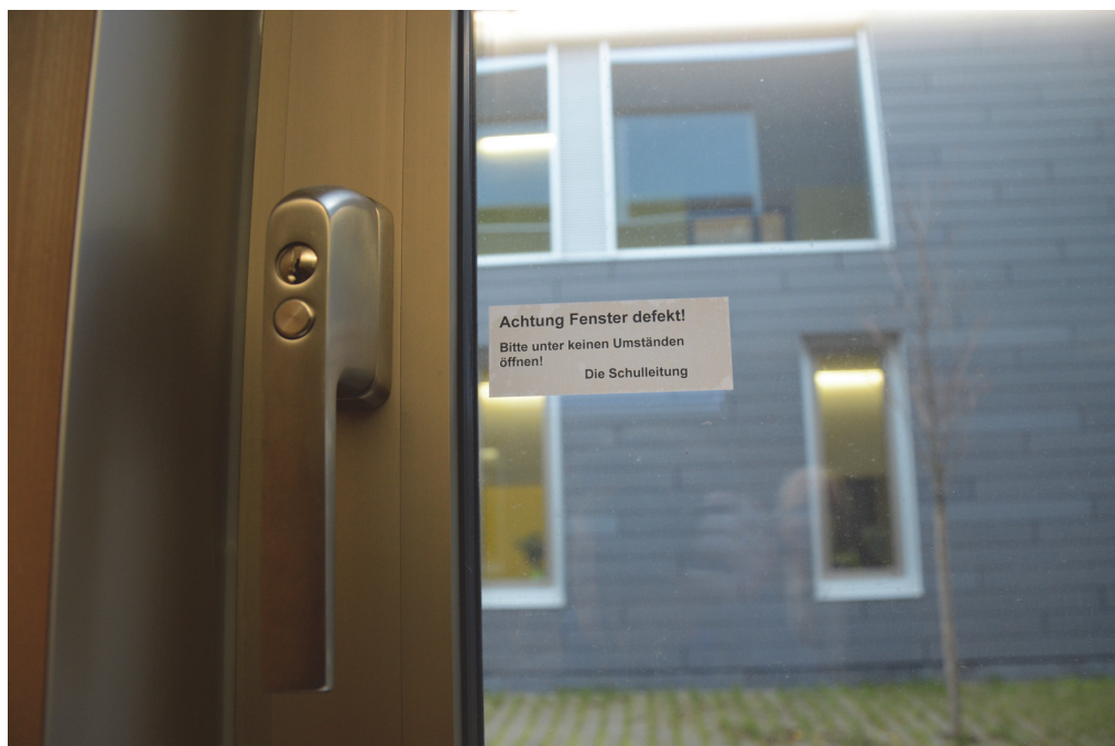
Bild 2 Maßnahmen nach dem Versagen der Konstruktion: Hinweise und Sicherung des Flügels durch Stillegung
