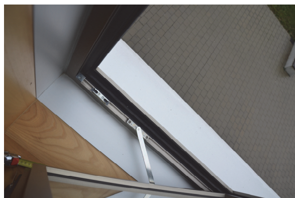
Bild 8 Der Öffnungswinkel und damit die freie Öffnung werden durch Öffnungsbegrenzer bestimmt – hier: Flügel in Endlage und dadurch geringe Öffnungsweite
