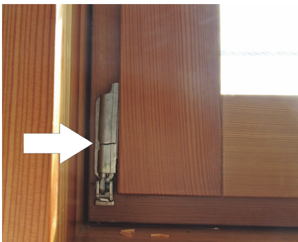
Bild 5 Bruch im Ecklager durch wiederholtes Anschlagen bzw. durch Belastungen in der geöffneten Endlage
