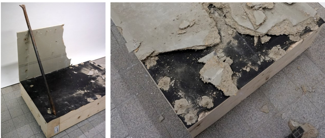
Abbildung 108: Trennung der zementgebundenen Spanplatte vom Holzständerwerk (eigene Darstellung)
