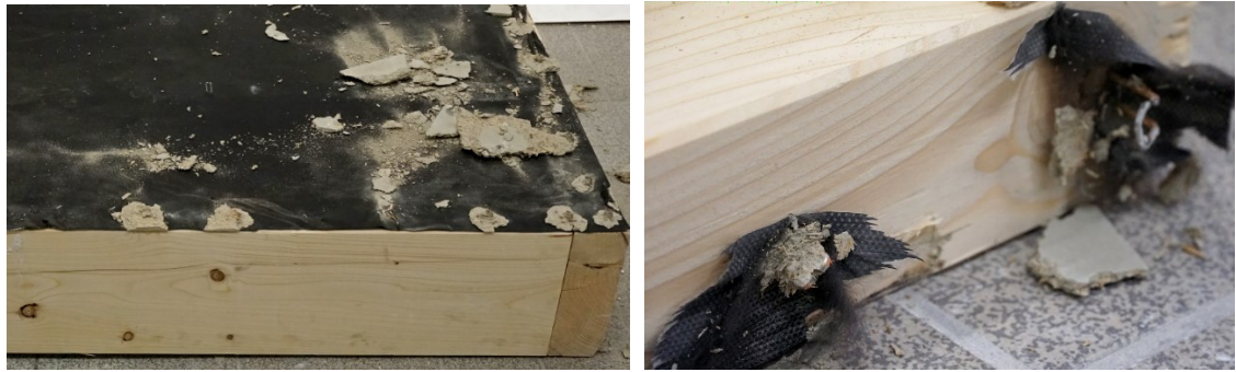
Abbildung 109: Trennung der Unterspannbahn vom Holzständerwerk (eigene Darstellung)
