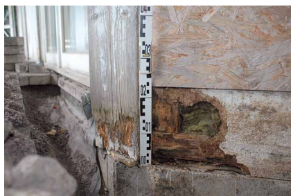
Nach Freilegung sichtbar gewordener Pilzschäden am Holz im erdberührten Bereich
