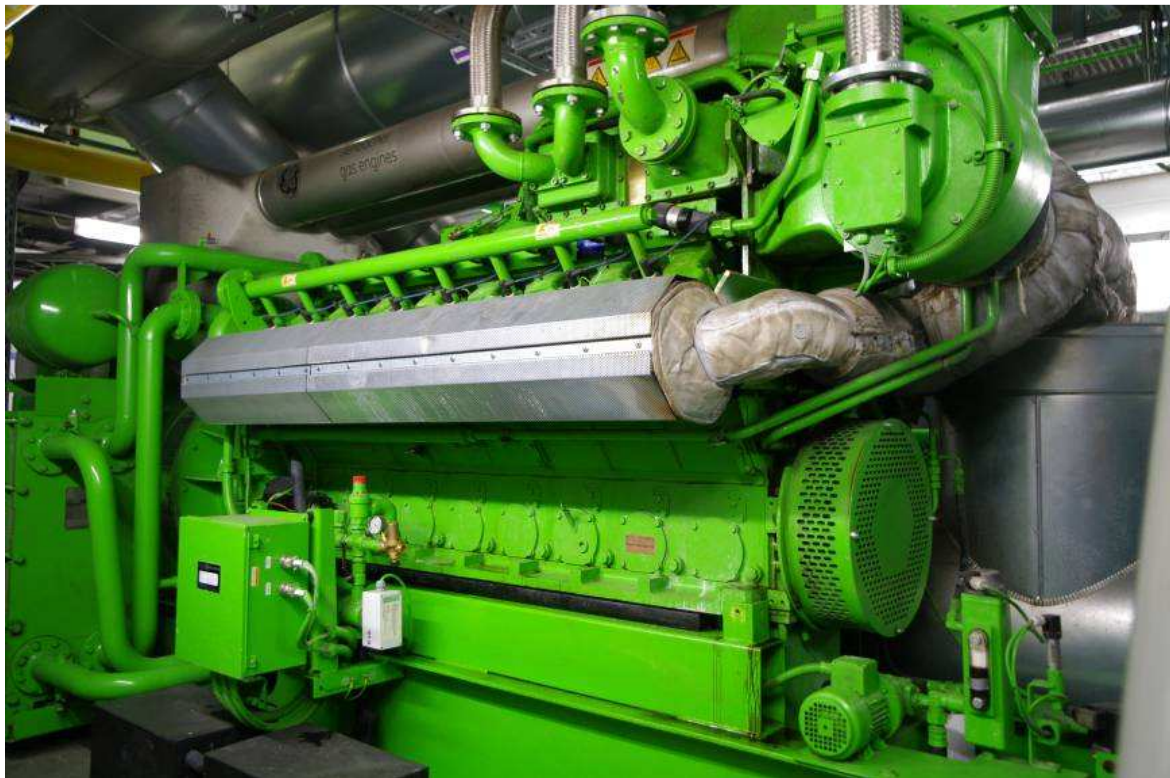
Abbildung 2: Beispiel für ein Biomethan-BHKW-Modul
