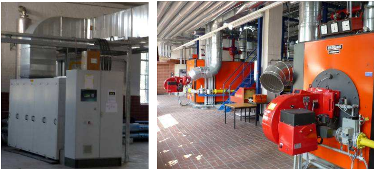
Abbildung 33: BHKW-Modul (links) und Spitzenlastkessel (rechts) Anlage 15
