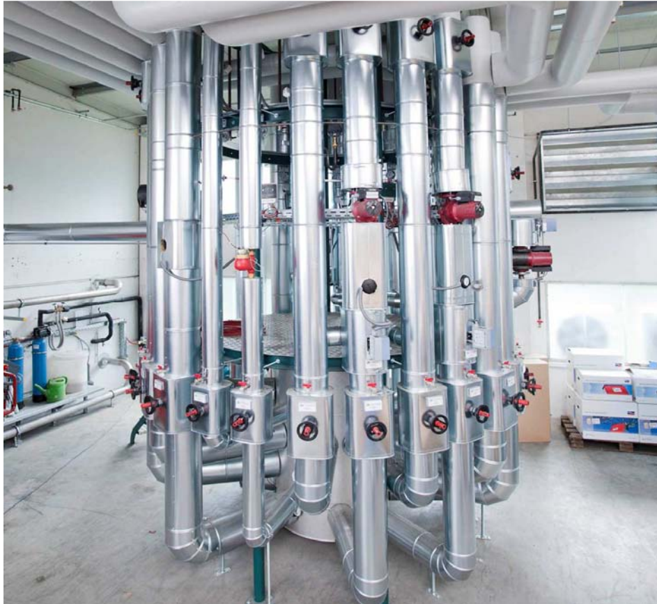
Abbildung 10: Mehrstufiger Zortström-Verteiler für ein Fernwärmenetz mit multivalenter Heizanlage [Bildnachweis: Burkhardt GmbH]
