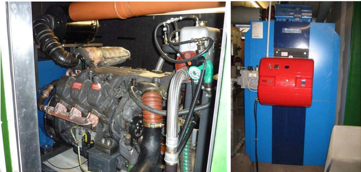
Abbildung 35: BHKW-Modul (links) und Spitzenlastkessel (rechts) Anlage 17
