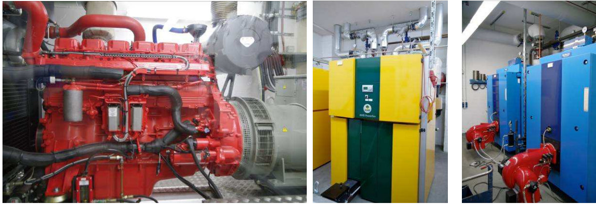
Abbildung 21: BHKW-Modul, Hackschnitzelkessel und Spitzenlastkessel Anlage 4 (von links)
