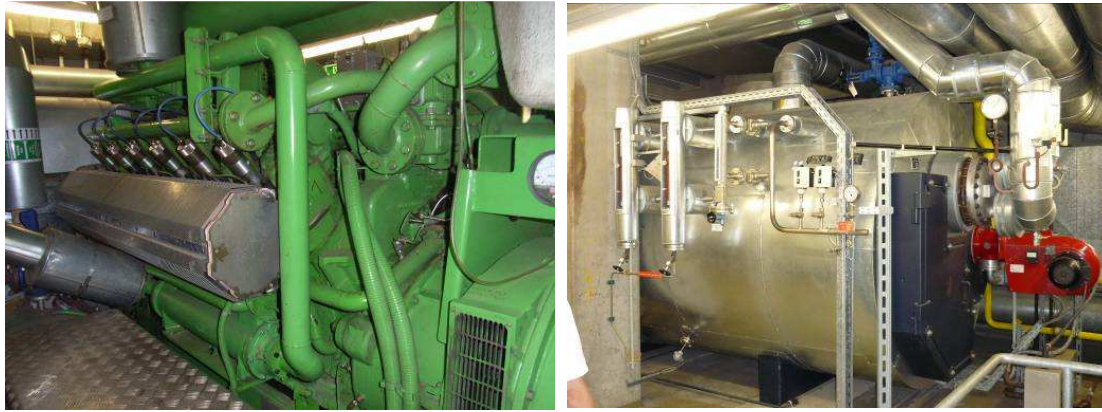
Abbildung 32: BHKW-Modul (links) und Austreiberkessel (rechts) Anlage 14
