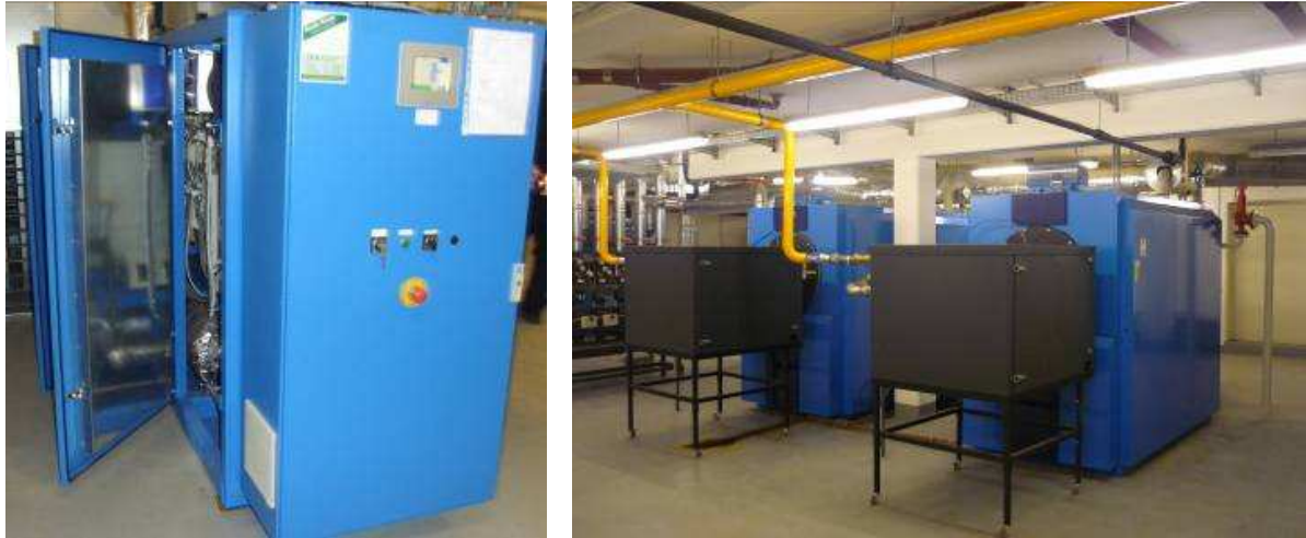
Abbildung 28: Von links: BHKW-Modul (links) und Spitzenlastkessel (rechts) Anlage 10
