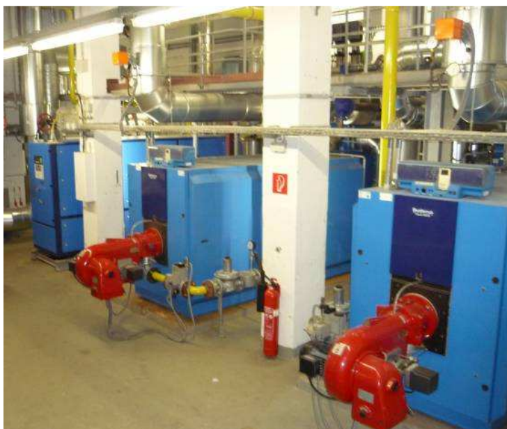
Abbildung 34: BHKW (links) und Spitzenlastkessel (rechts) Anlage 16
