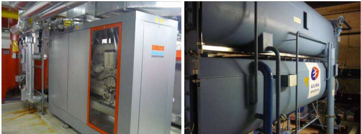
Abbildung 27: BHKW-Modul (links) und Absorptionskälteanlage (rechts) Anlage 9
