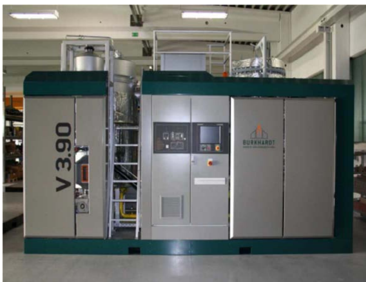
Abbildung 62: Holzvergasungsanlage zur Gaserzeugung für ein BHKW mit 180 kW el [Bildnachweis: Burkhardt GmbH]
