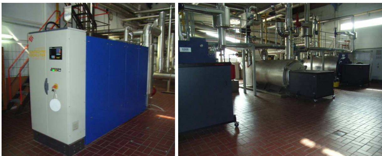
Abbildung 29: BHKW-Modul (links) und Spitzenlastkessel (rechts) Anlage 11
