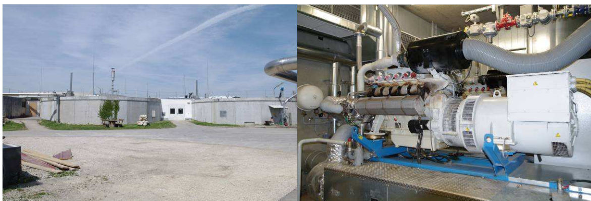
Abbildung 23: Fermenter (links) und BHKW-Modul (rechts) Anlage 7
