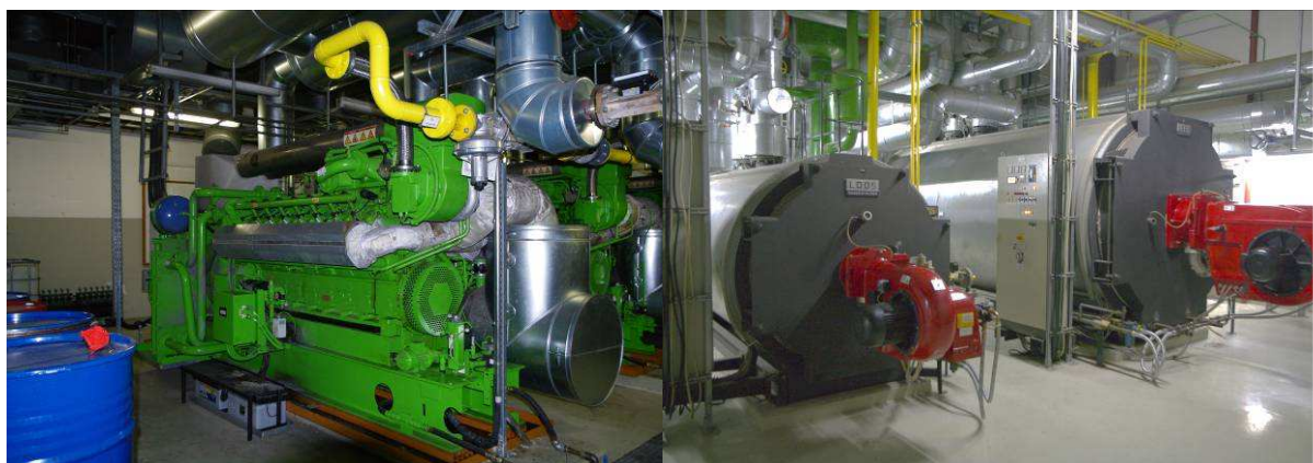
Abbildung 20: Biomethan-BHKW-Modul (links) und Spitzenlastkessel (rechts) Anlage 2 und 3
