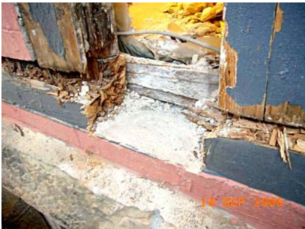
Abb. 1 Geöffneter Wandaufbau, deutlich erkennbar die starke Zerstörung der Schwellhölzer und aufgehenden Ständer durch Braun- und Weißfäule. Im Hintergrund ist die Glasfaserdämmschicht zu sehen. (privat, Holzschutzgutachter)
