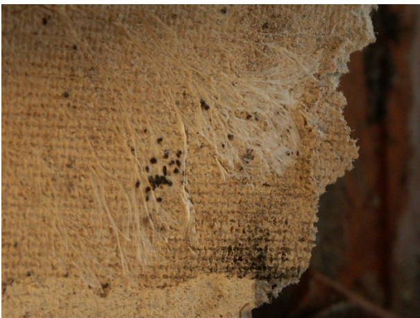
Abb. 3 ausgeprägtes Pilzmyzel auf der Rückseite der Gipskartonlage einer Verbunddämmplatte aus Styropor und Gipskarton (DFWZ QLB)
