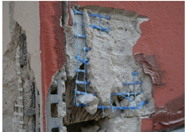
Abb. 4 Ausführungsmangel: Die Gewebeeinlage in der Putzschicht endet ca. 2 cm vor der Außenecke und wird nicht herumgeführt. Das Eckprofil ist nicht systemkonform und wurde nur unzureichend am Untergrund befestigt. (DFWZ QLB)
