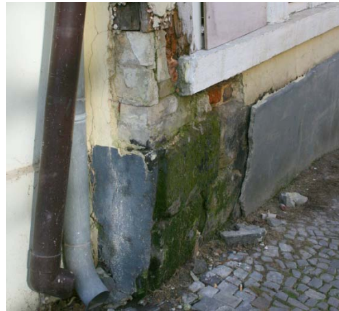
Abb. 2 Der Zementputz löst sich scheibenförmig von den Sandsteinen ab. Durch eine schadhafte Dachentwässerung wurde der Feuchteintrag zusätzlich forciert, so dass sich im Schwellholz und im aufgehenden Ständer holzerstörende Pilze ausbreiten konnten. Die Sandsteine sind mit Algen und Moosen bewachsen. (DFWZ)
