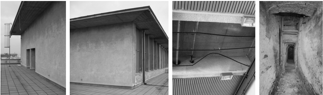
Abbildung 1: Versuchsobjekte (von links nach rechts) Fassade Vorhoelzer-Bau (zwei Bilder), Deckenfeld Meyer-Jens-Halle, Kellerraum Gabelsbergerstraße
