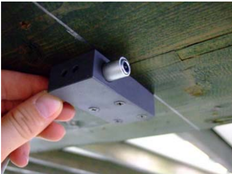
Abbildung 8: LED eines Messpunktes während der Montage mit Halterung aus Stahl
