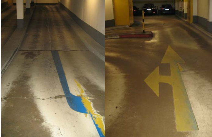
Bild 1: Verschleiß von Oberflächenschutzsystemen im Bereich von Rampen und Kurven in einem Parkhaus
