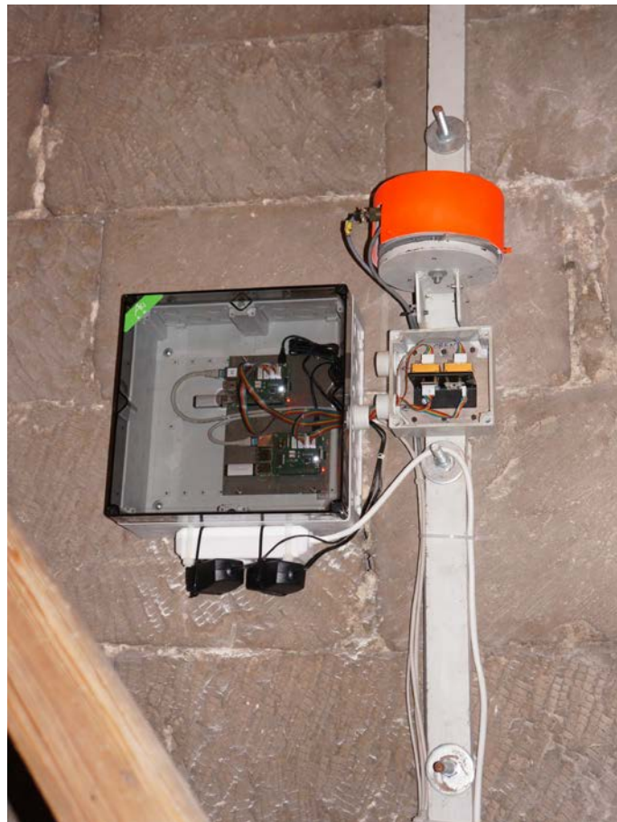
Bild 4: Installiertes Neigungsmesssystem am Referenzobjekt Kirchturm
