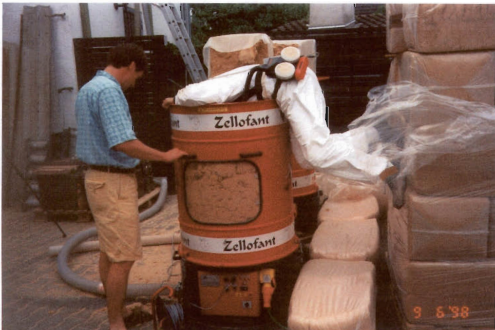
Bild 13: Unsachgemäßes Beseitigen einer Verstopfung in der Einblasmaschine
