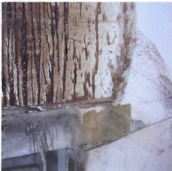
Abbildung 7.15: Schäden an der PS-Hartschaumdämmung
