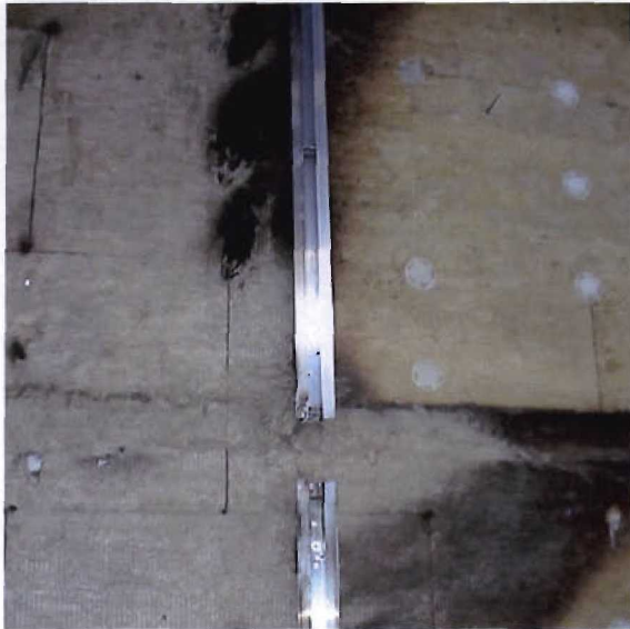
Abbildung 7.13: Schäden an der Mineralfaserdämmung
