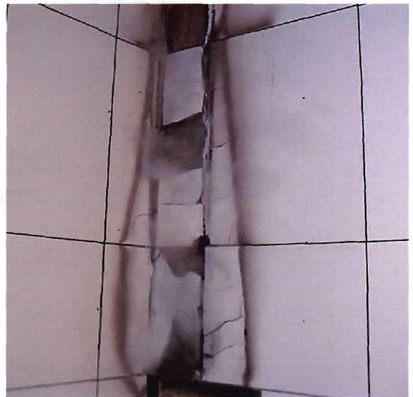
Abbildung 7.12: Risse bei einer Holzunterkonstruktion durch Zwängungen
