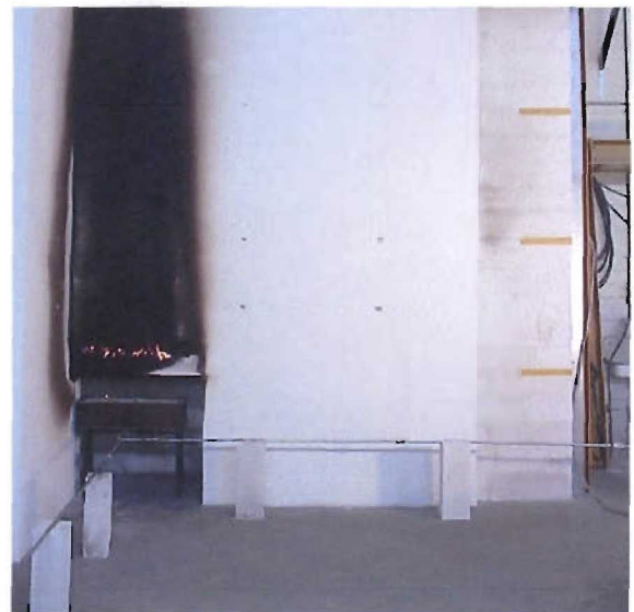
Abbildung 7.16: Schäden an der Putzoberfläche
