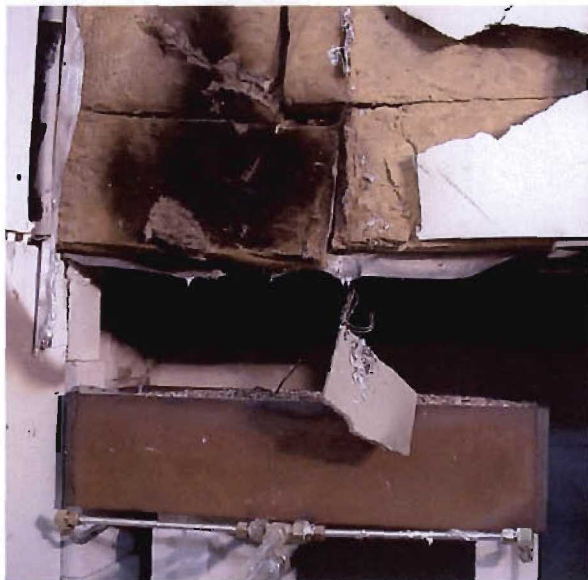
Abbildung 7.11: Geschmolzene und verformte Aluminium-Unterkonstruktion
