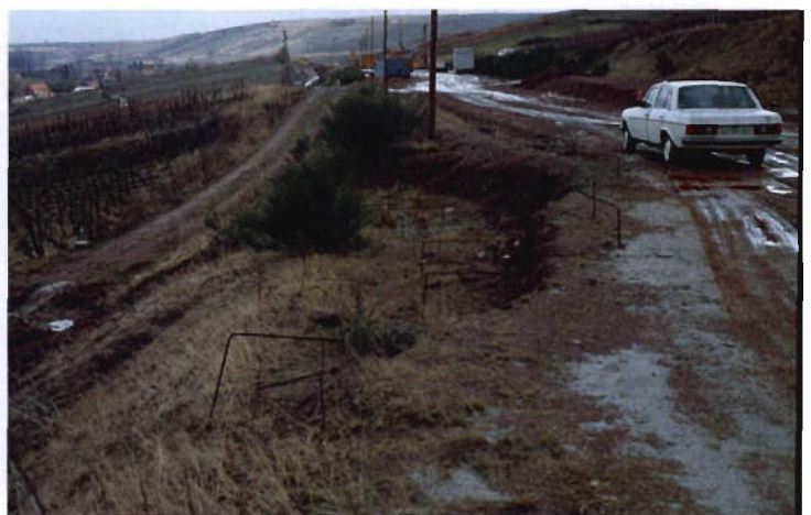
Bild 3.5-2 Rutschung am östlichen Dammwiderlager
