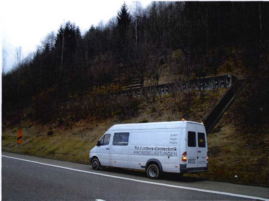
Bild 3.3-5 Verankerte Böschung im Jahr 2002
