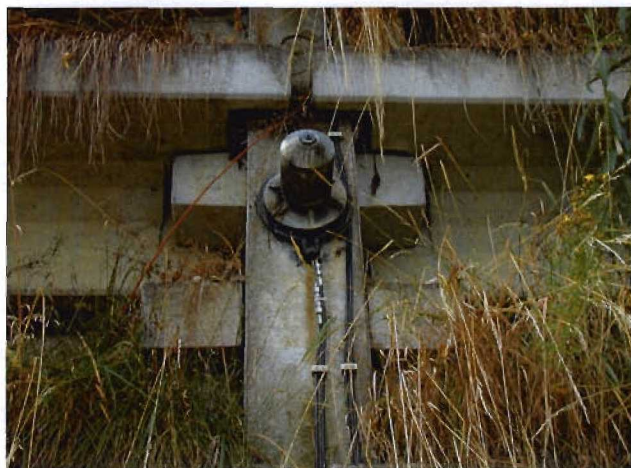
Bild 3.1-6 Stationäre Kraftmesseinrichtung an einem Ankerkopf auf einer Lisene
