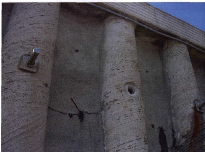
Bild 4-15 Beschädigung eines Ankers mit nachfolgendem Korrosionsversagen durch Drainagebohrungen
