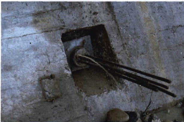
Bild 4-7 Wasseraustritt aus der Verkeilung eines Litzenankers (Foto: Dipl.-Ing. Meiniger)
