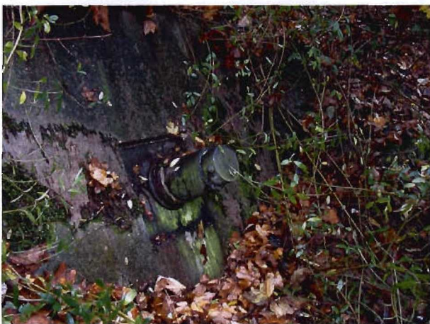
Bild 3.11-3 Ankerkopf auf Betonplatte
