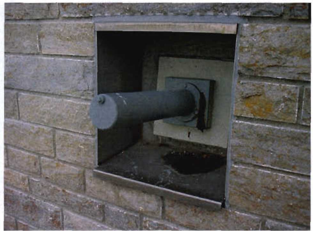
Bild 3.12-6 Ankerkopf, austretende Korrosionsschutzpaste
