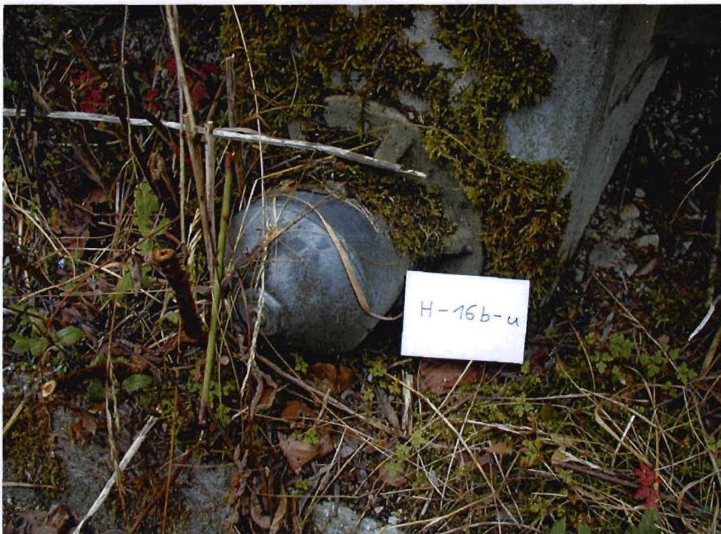
Bild 3.1-15 Anker H-16b-u ca. 16 Jahre nach dem Einbau
