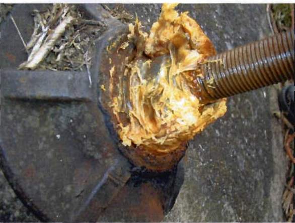
Bild 3.4-5 Ankerkopf mit Korrosionsschutzpaste
