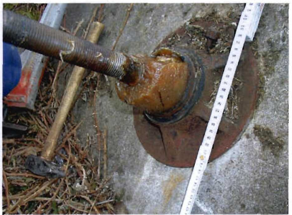
Bild 3.4-6 Ankerkopf mit Korrosionsschutzpaste
