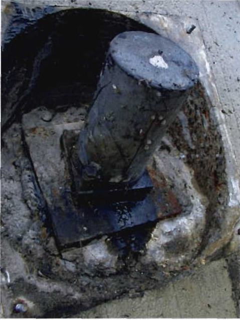
Bild 3.6-17 Zusatzanker nach Abnahme der Blechhaube
