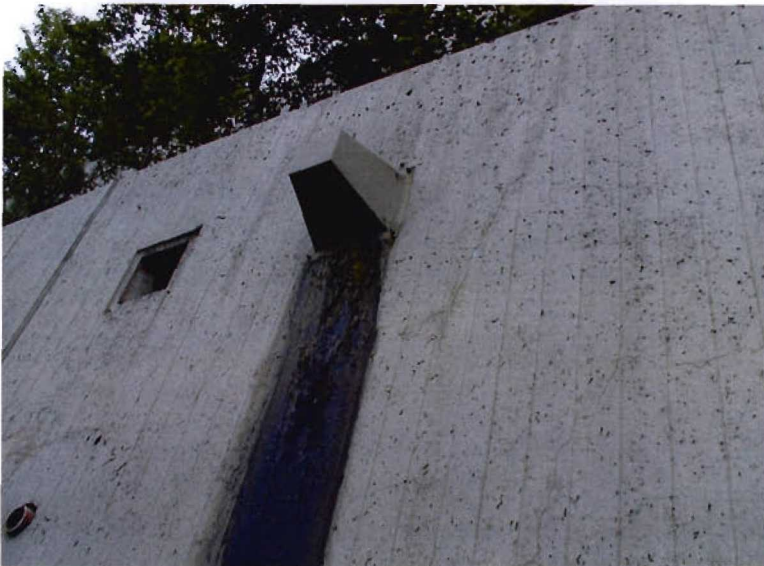
Bild 3.6-22 Zusatzanker mit Wasseraustritt (2002)
