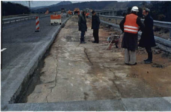
Bild 3.2-2 Risse in der Frostschuttschicht
