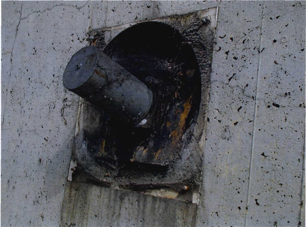
Bild 3.6-15 Zusatzanker nach Abnahme der Blechhaube
