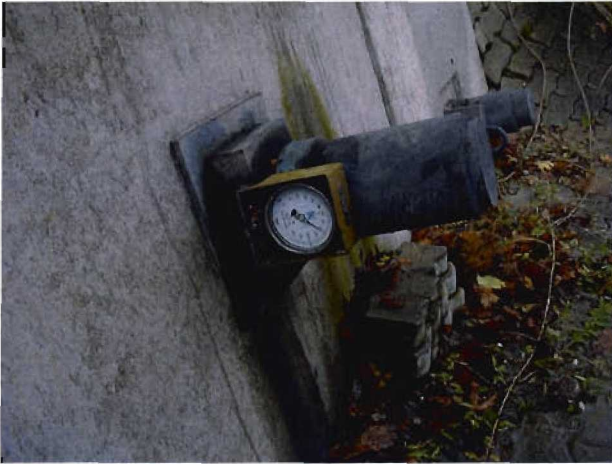
Bild 3.10-3 Manometeranzeige am nördlichen Widerlager
