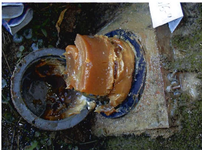
Bild 3.1-32 Ausreichende Korrosionsschutzpaste in gutem Zustand
