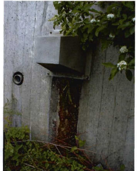
Bild 3.6-23 Zusatzanker mit Wasseraustritt (2002)
