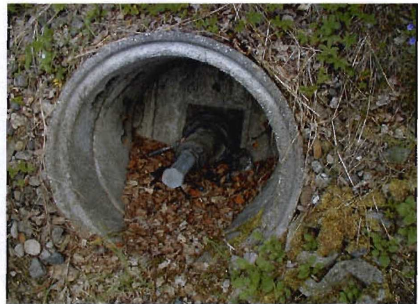
Bild 3.7-12 Kontrollanker in der Böschung (2002)
