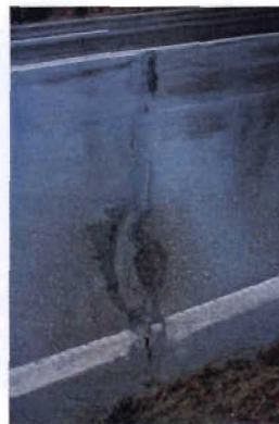
Bild 3.13-2 Riß in der Fahrbahn
