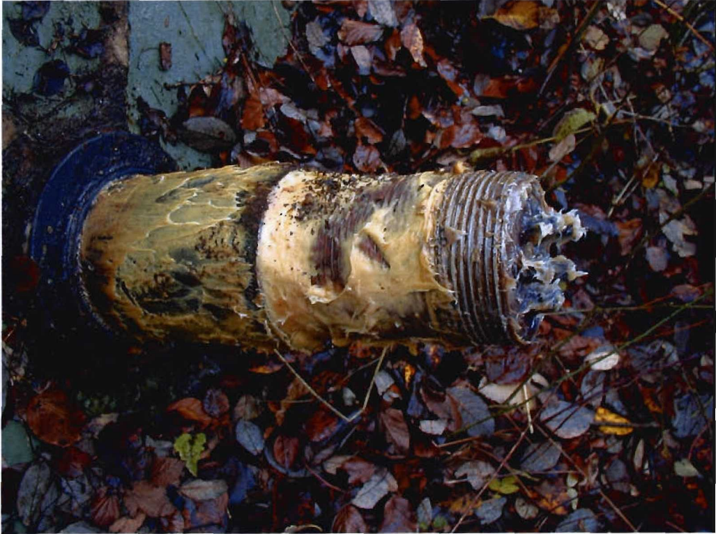
Bild 3.13-11 Keilträger mit Korrosionsschutz
