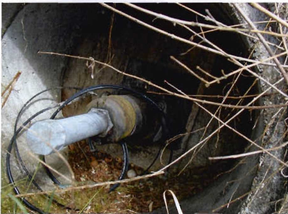
Bild 3.7-11 Kontrollanker in der Böschung (2002)
