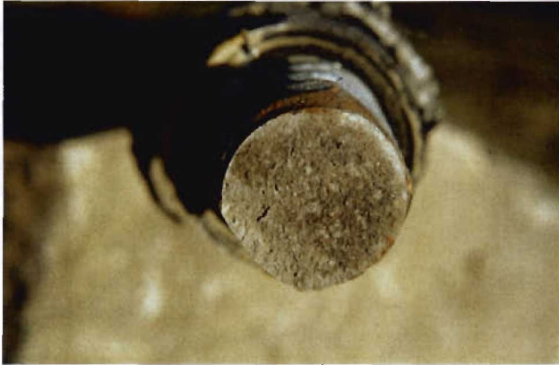
Bild 4-13 Stahlbruch neben einer Muffe, Bruchstelle (Foto: Dipl.-Ing. Meiniger)
