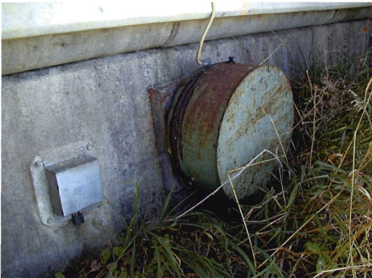
Bild 3.1-8 Fest installierte Abhebepresse im Jahr 2001
