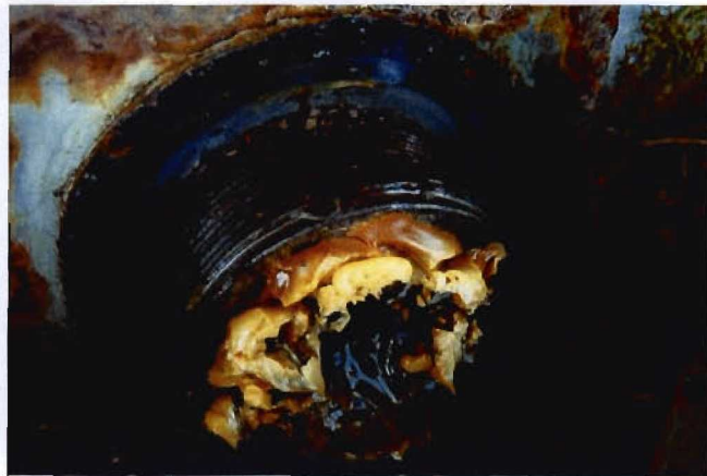
Bild 3.1-31 Rost am Außengewinde des Keilträgers
