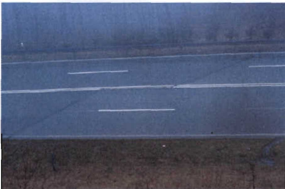
Bild 3.13-1 Fahrbahn der B 500 an der Schadensstelle
