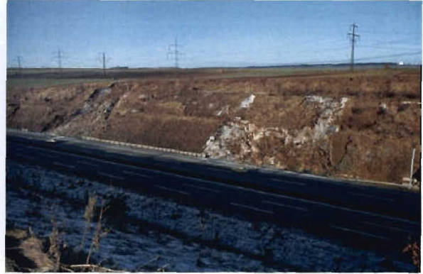
Bild 3.2-3 Rutschungen in der anschließenden Einschnittböschung
