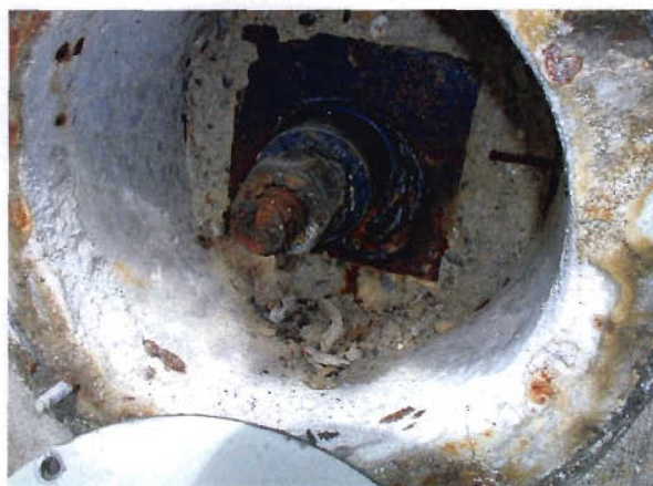
Bild 3.6-10 Kopf eines Einstabankers (Ankerkraft reguliert nach Freilegung)
