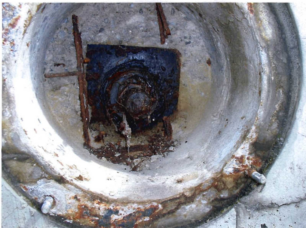
Bild 3.6-12 Kopf eines Einstabankers (Ankerkraft reguliert nach Freilegung)
