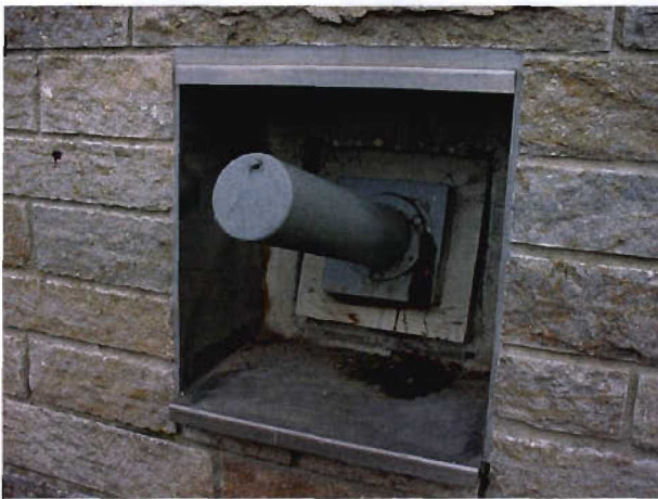
Bild 3.12-5 Ankerkopf, austretende Korrosionsschutzpaste
