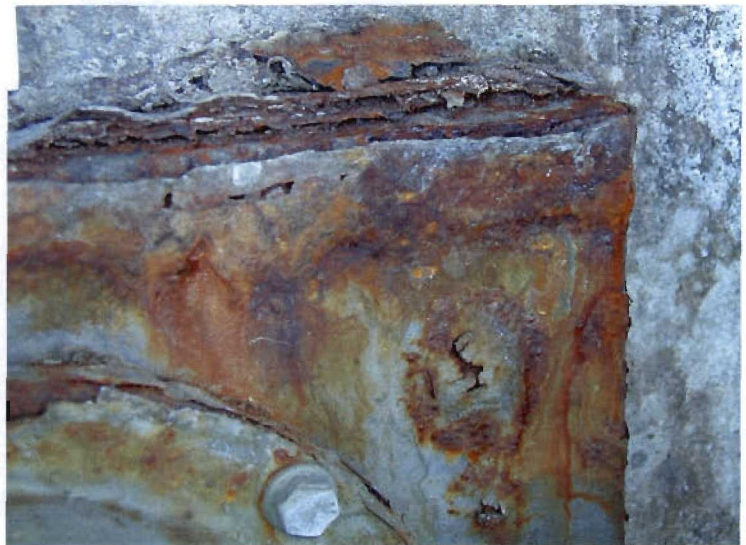
Bild 3.1-29 Ablätzungen infolge Rost
