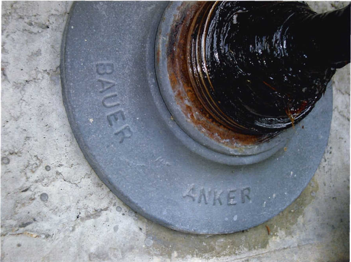
Bild 3.2-16 Geringfügige Korrosion an einer Kalotte
