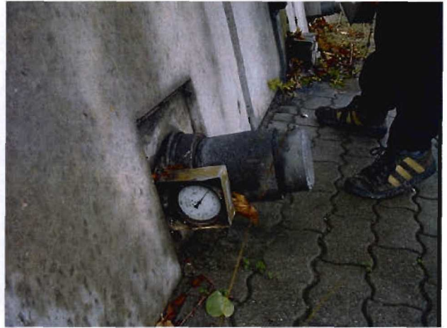
Bild 3.10-4 Manometeranzeige am nördlichen Widerlager
