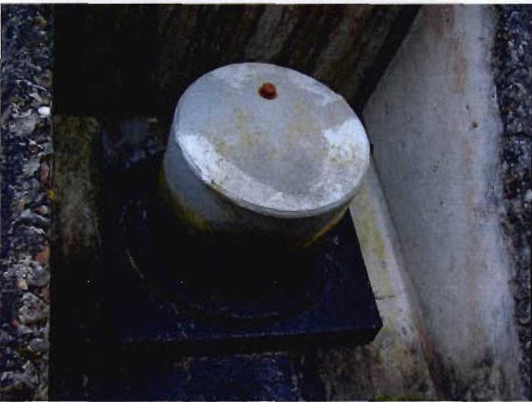
Bild 3.3-13 Kappe mit ausgetretener Korrosionsschutzpaste
