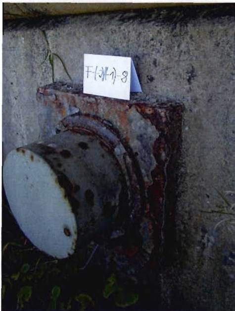
Bild 3.1-28 Rostschäden am Anker F-(-2)/(-1)-8
