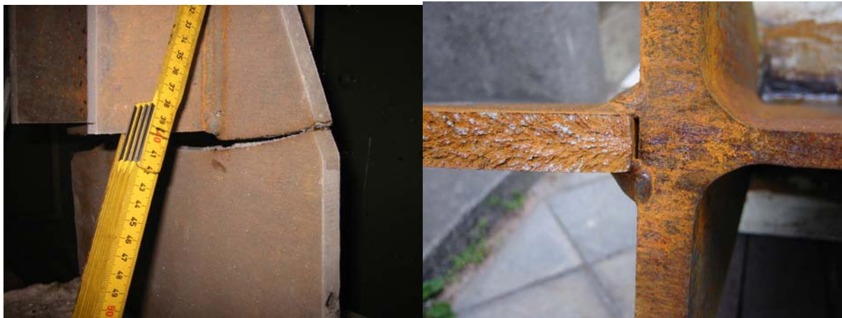
Bild 5.2 V112 im Bruchzustand (links), instabiler Rissfortschritt nach geringer Plastizierung vor Rissbeginn (Bruchfläche, rechts)
