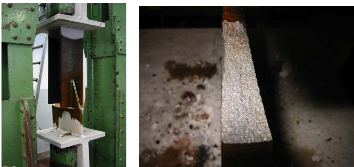
Bild 5.3 V113 im Bruchzustand (links), instabiler Rissfortschritt nach geringer Plastizierung vor Rissbeginn (Bruchfläche, rechts)
