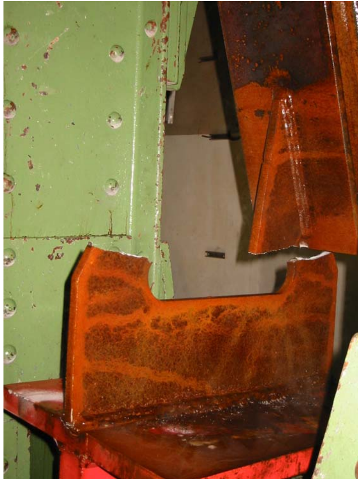
Bild 5.4 V121 im Bruchzustand, instabiler Rissfortschritt nach mäßiger Plastizierung vor Rissbeginn
