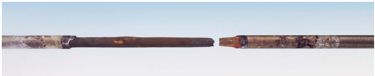
Abb. 26: Spannstab – ohne Korrosionsschutzmasse - nach 609 Tagen in der Lösung gerissen
