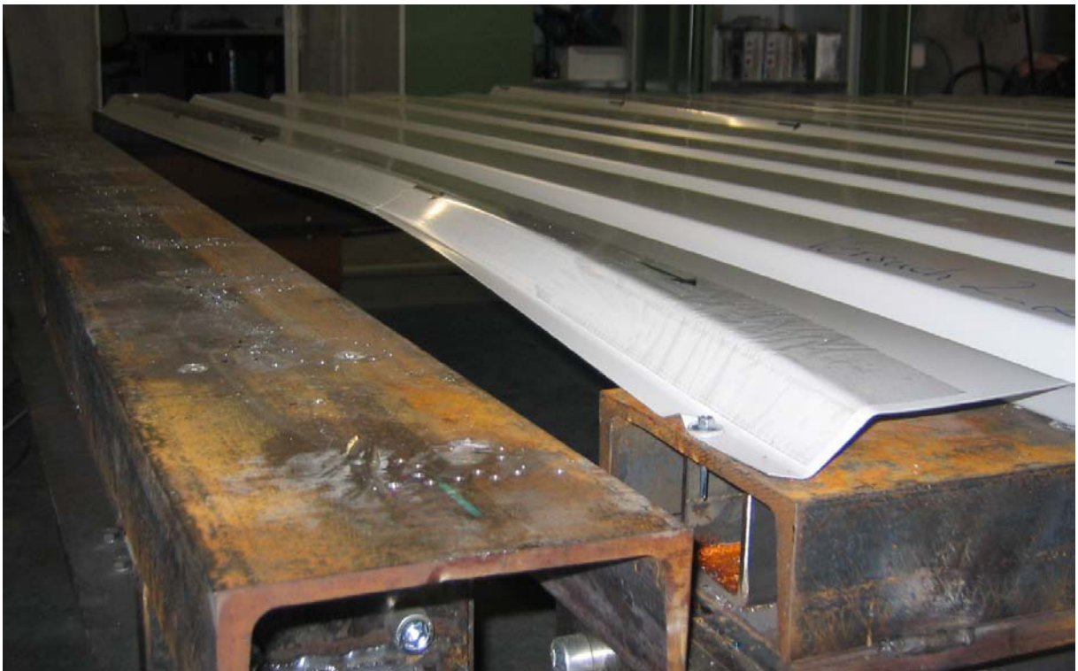
Bild 5: deutliche Verformung der druckbeanspruchten Randrippe bei etwa 105kN
