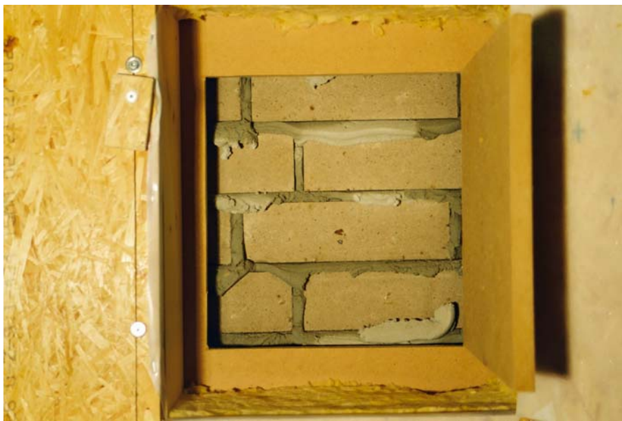
Abbildung 14: Durchfeuchtung der Mörtelfugen auf der Rückseite der Mauerwerkvorsatzschale in der Wand A
