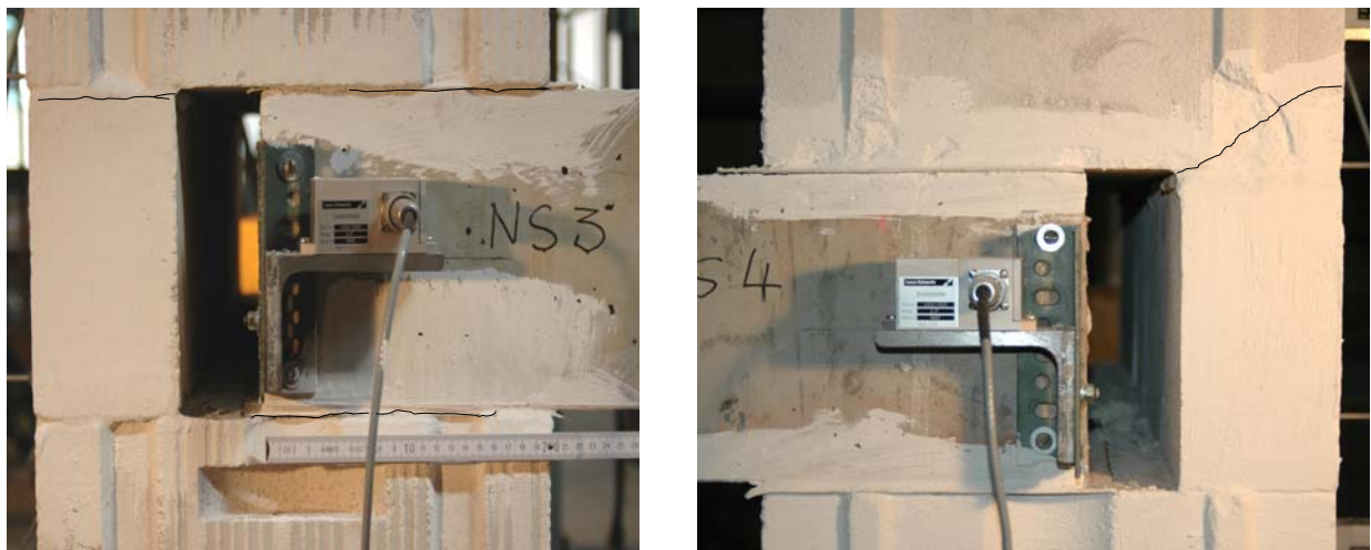
Bild 23 Rissbildung im Knotenbereich (links: Riss oberhalb- und unterhalb des Deckenaufagers und am Vormauerstein auf der südlichen Seite; rechts: Riss des Wandfußes der oberen Wand oberhalb des Vormauersteins auf der nördlichen Seite)
