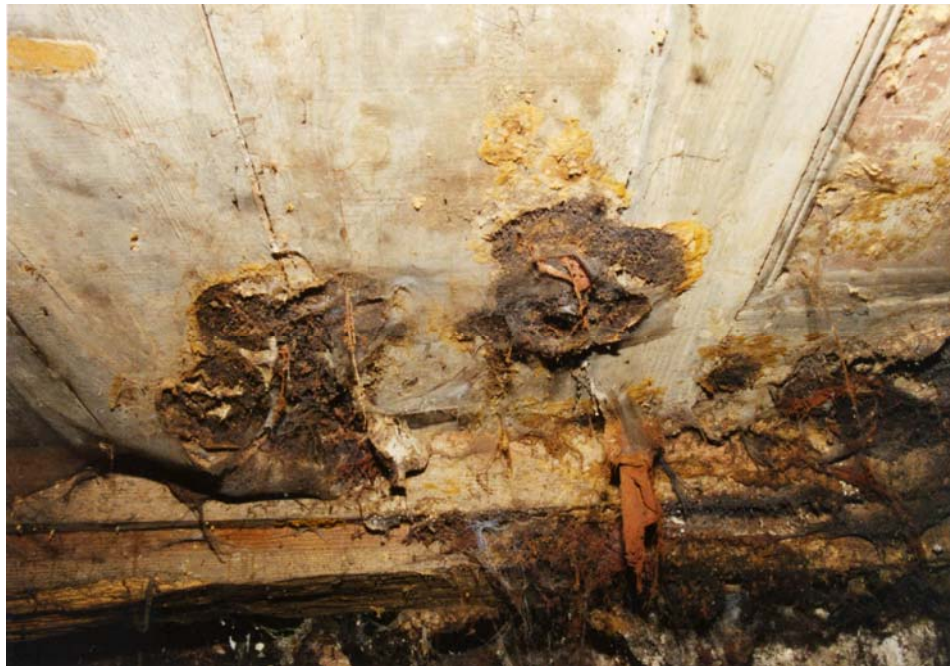
Abb. 4: Vom Echten Hausschwamm befallener Einschub aus bauzeitlichen Füllungen.
