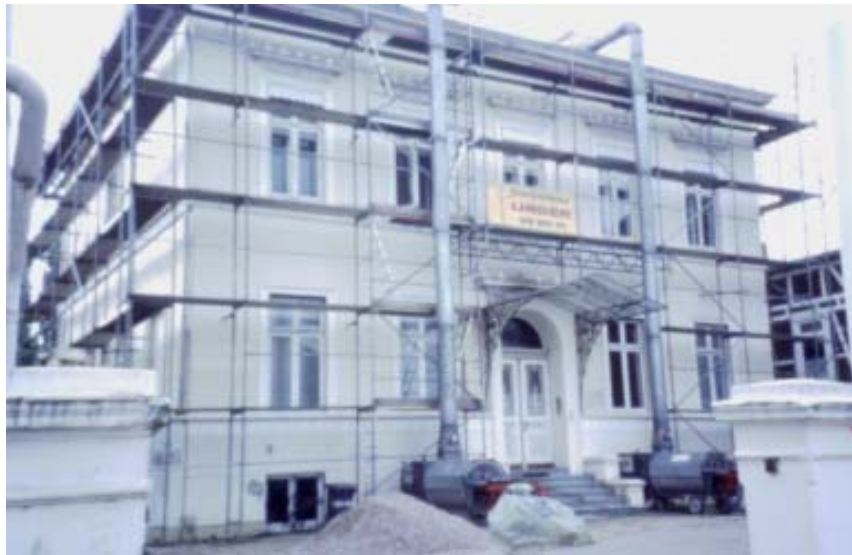
Abb. 4: Heizgeräte und Zuluftrohre vor dem Gebäude.
