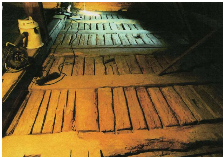
Abb.3: Dachstuhl, Südseite - Dippeldecke mit Altschäden durch Nassfäulepilze.
