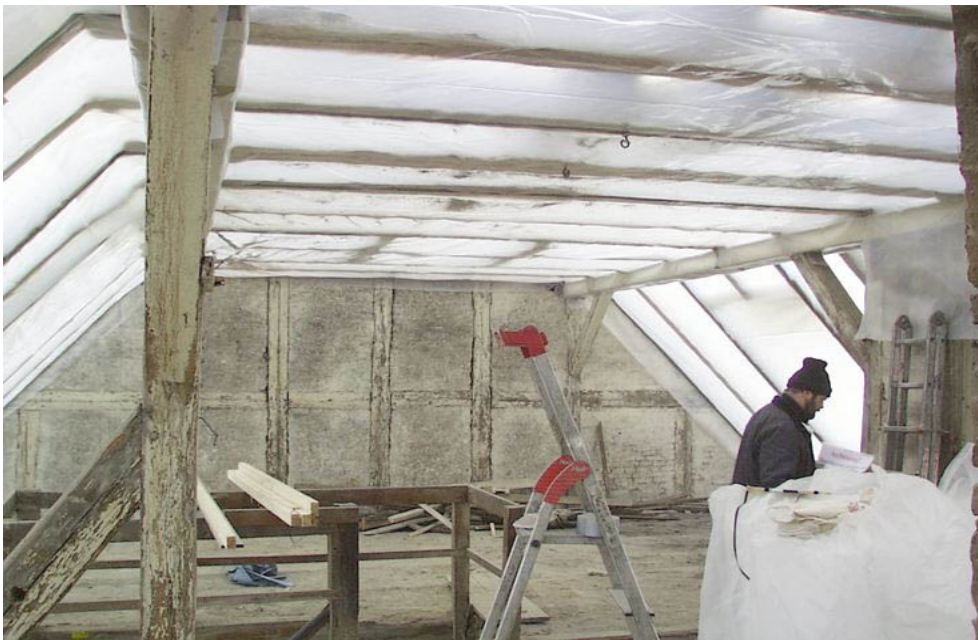
Abb. 8: Dachstuhl mit Abplanung.
