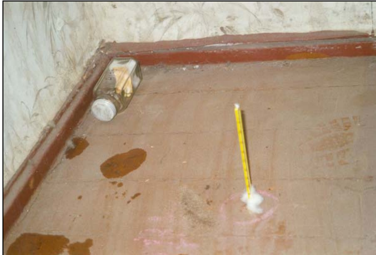
Abb. 9: Ausgelegter Prüfkörper mit hausschwammbefallenem Kiefernklötzchen und Flüssigkeitsthermometer.
