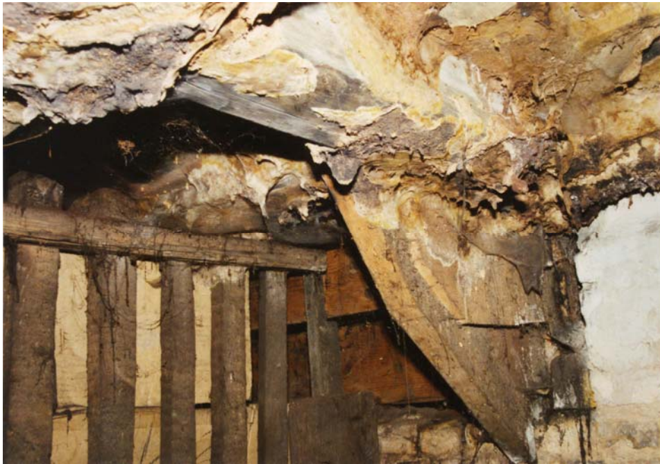
Abb. 3: Vom Echten Hausschwamm überwucherte Holzbalkendecke und Treppenunterseite.
