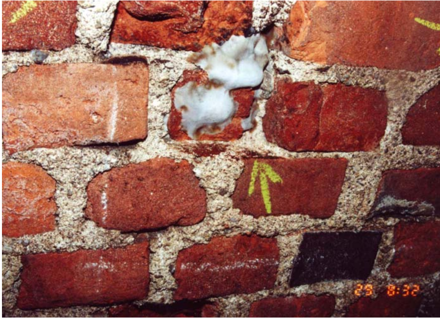
Abb. 3: Myzel des Echten Hausschwamms auf der Mauerwerksoberfläche.
