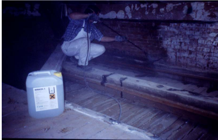
Abb. 7: Fluten der Wand oberhalb der Bohrlochsperrung und Spritzen der verbliebenen Balken sowie der Deckenschalung.
