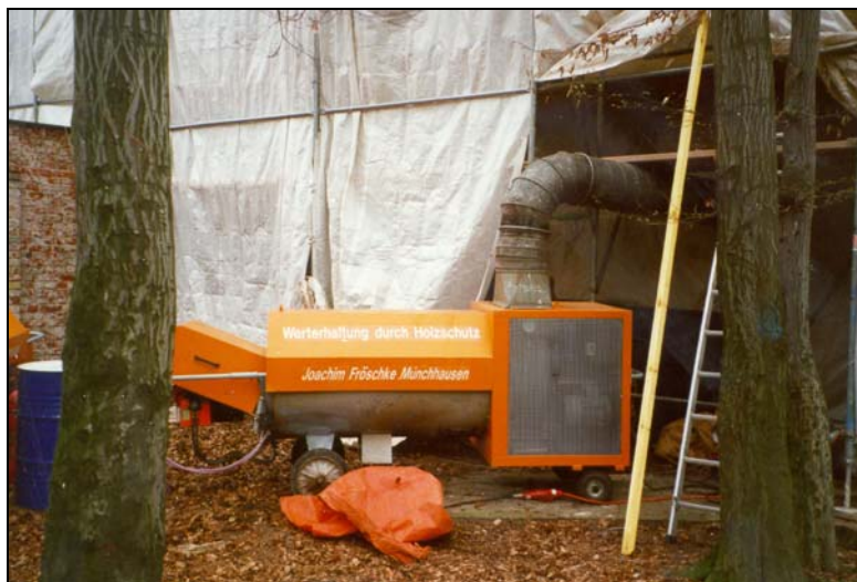
Abb. 6: Die vom Ölbrenner erzeugte Heißluft wird in das Gebäude eingeblasen.
