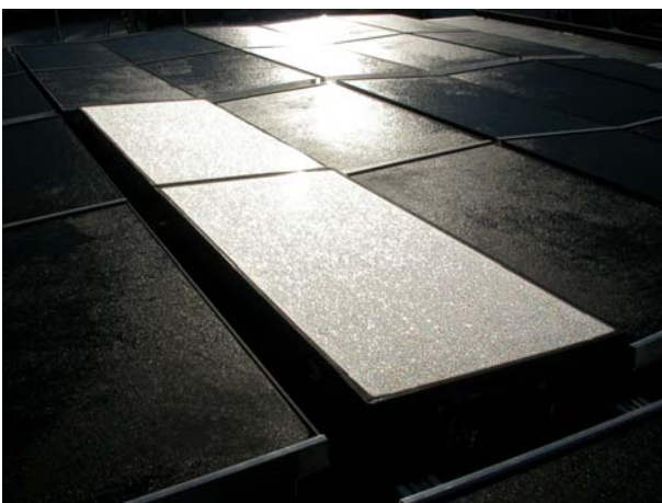
Abb. 6.3.: Solarthermische Anlage auf dem Dach des SD Haus. Quelle: FG ee
