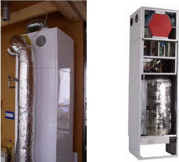
Abb. 6.5.: Einbausituation des Lüftungskompaktgerätes. Quelle: FG ee
