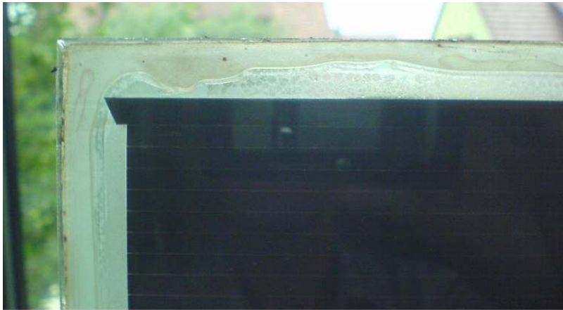
Abbildung 9 Eingedrungene Feuchtigkeit als sichtbarer Niederschlag im Randbereich nach 500 h im Feuchte-Wärme-Test
