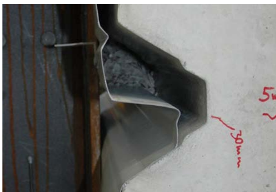
Bild 7-22: Nahaufnahme Betonausbruch Sicke 1 von Versuchskörper V4-TK-2f
