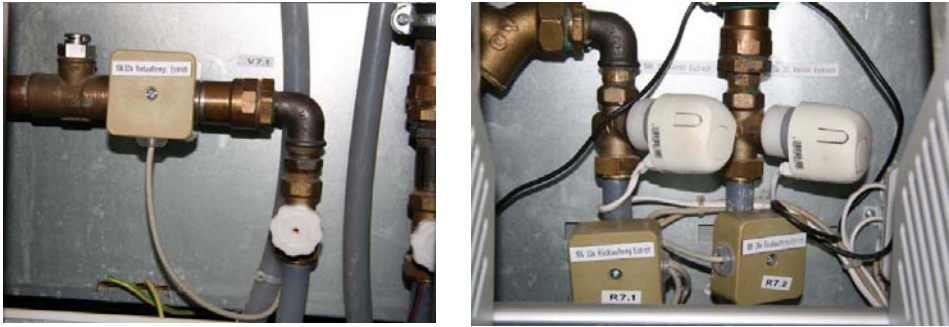
Bild 5-9: Messfühler zur Erfassung der Vorlauftemperatur (links) und der Rücklauftemperatur (rechts) sowie Regelventile (ebenfalls rechts).
