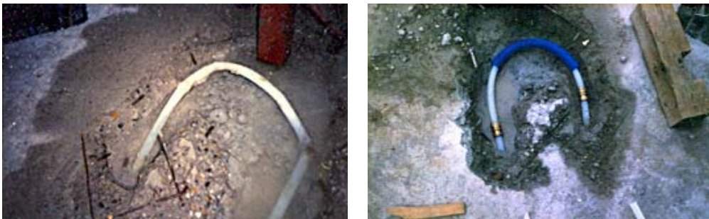
Bild 2-4: Während des Innenausbaus beschädigtes (links) und repariertes Rohr.
