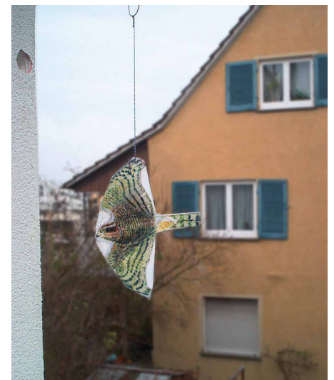
Abb. 8: Der unmittelbar angrenzende Wald hat einen Specht an diese Hausfassade gelockt. Ein Spechtloch an der Hauskante war die Folge. Den Rat zu Windspiel oder Vogelsilhouette hat der Hausbesitzer kombiniert und einen Kinder-Flugdrachen, mit der Abbildung eines Greifvogels, zur Abwehr eingesetzt. Ließ der Wind den Drachen zu Boden fallen, war der Specht sofort wieder am Loch. Nach besserer Befestigung war auch der Erfolg gegeben: Nach mehrtägigem Schimpfen aus sicherer Entfernung hat der Vogel aufgegeben. (Bild: Cisch)
