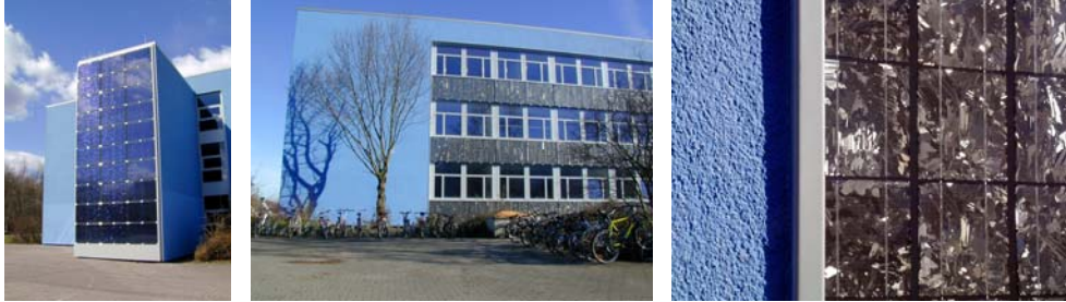
Abb. 52 PV-Kaltfassade zur Verkleidung der SO-Fassade eines Treppenhauses, Quelle: Raumplan Architekten
