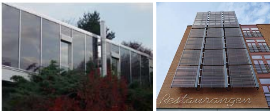
Abb. 18 Fassadenintegration solarthermischer Module; Quelle: www.reyelts.de
