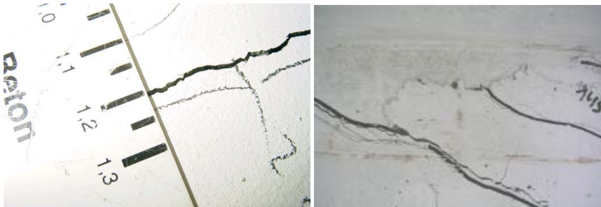
Bild 5.16: links: Rissbreite bei Abbruch des Versuchs Q SVB 1L rechts: leichte Betonschollen bei Versuch Q SVB 2L
