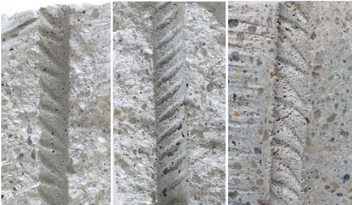
Abb. 29: Schnitt durch zerteilte Probekörper aus chromatreduzierten Betonen nach Entfernung der verzinkten Stähle; v.l.n.r.: CEM I, CEM II, CEM III
