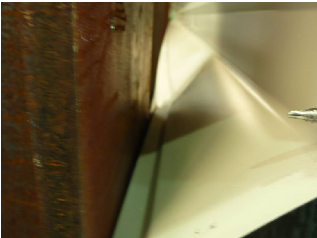
Abbildung A.43: Verformung des anliegenden Gurtes und des angrenzenden Stegs
