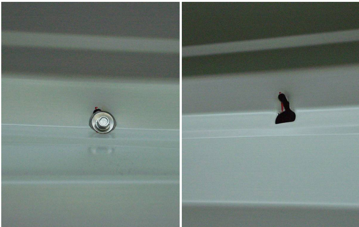
Abbildung A.10: Versagen der Verbindung mit der Unterkonstruktion
