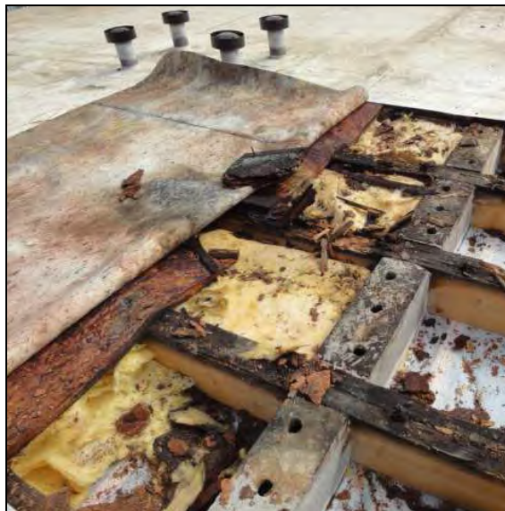
Abb. 33: Die Dachschalung war völlig zerstört, insbesondere im Bereich der innen liegenden Bäder
