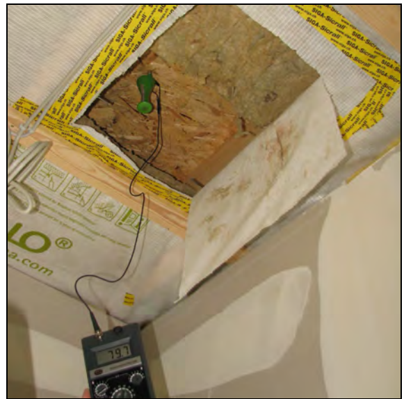
Abb. 38: Deutlich erhöhte Holzfeuchte auf der Unterseite der OSB-Schalung
