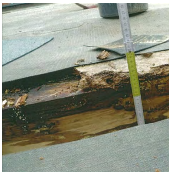
Abb. 29: Massive Durchfeuchtung der Dachschalung und der Sparrenoberseite
