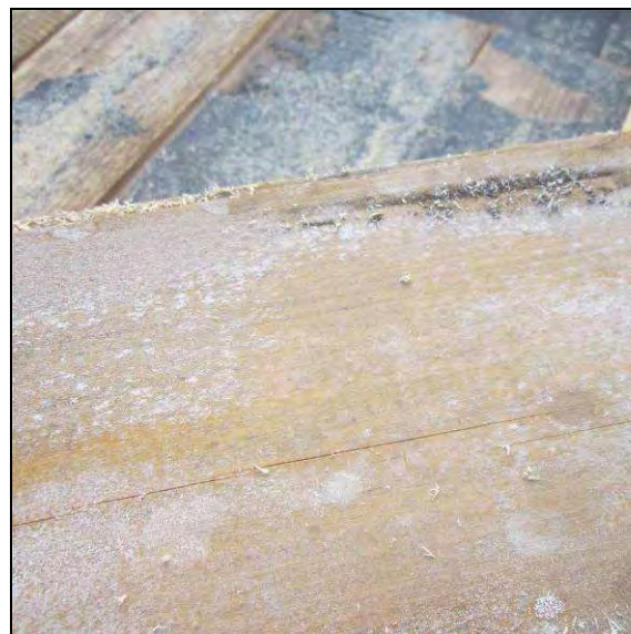
Abb. 43: Schimmelercheinungen auf der Dachschalung
