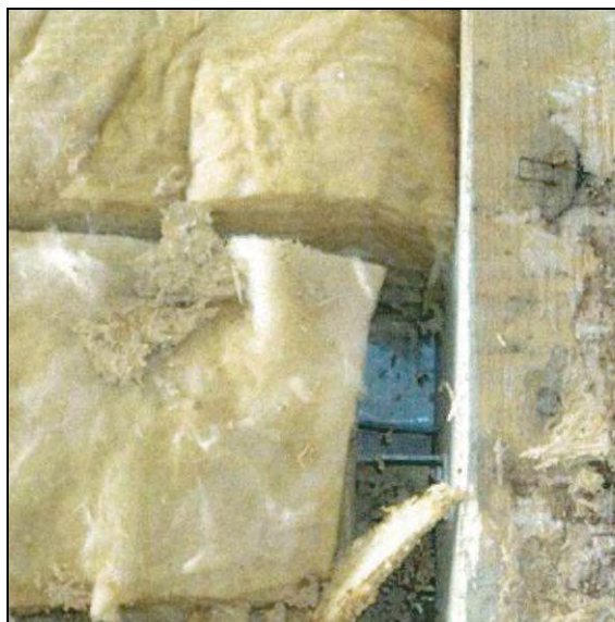
Abb. 22: Lückenhaft verlegte Wärmedämmung
