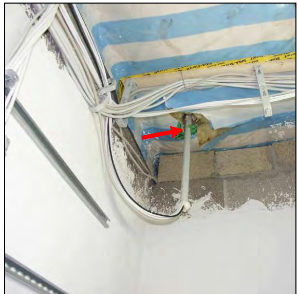
Abb. 16: Undichter Anschluss im Bereich einer Rohrdurchführung
