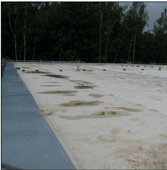
Abb. 37: Dachoberseite mit geringfügiger Pfützenbildung
