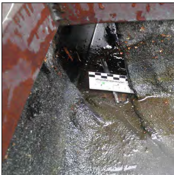
Abb. 27: Offene Fügenaht im Bereich des Dachablaufs
