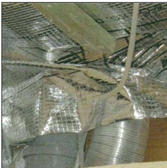
Abb. 21: Undichtigkeiten am Anschluss der Dampfsperre zu Rohrdurchführungen
