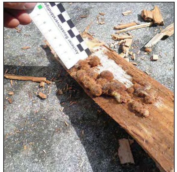
Abb. 26: Pilzbildung auf der Unterseite der Schalung
