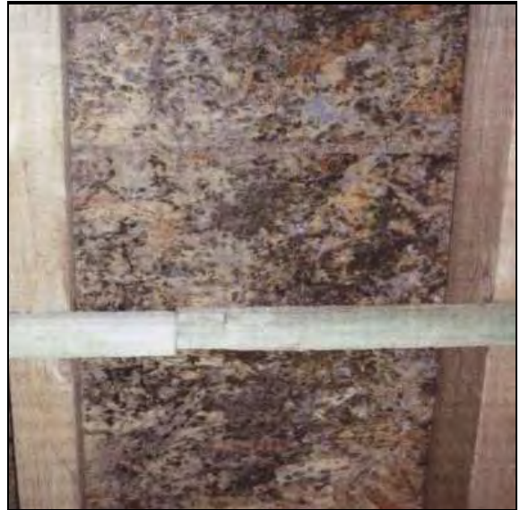
Abb. 14: Schimmelbildung auf der Unterseite der Dachschalung
