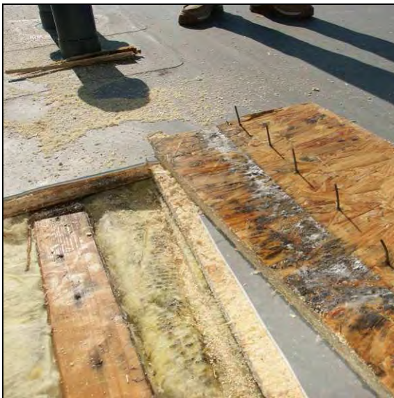
Abb. 15: Schimmelpilzbildung auf der Unterseite der Dachschalung, verrostete Nägel
