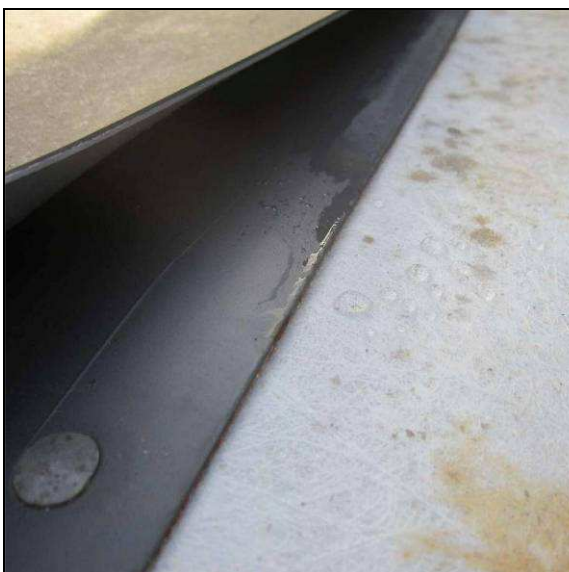
Abb. 44: Taufwassertropfen unmittelbar unter der Dachabdichtung
