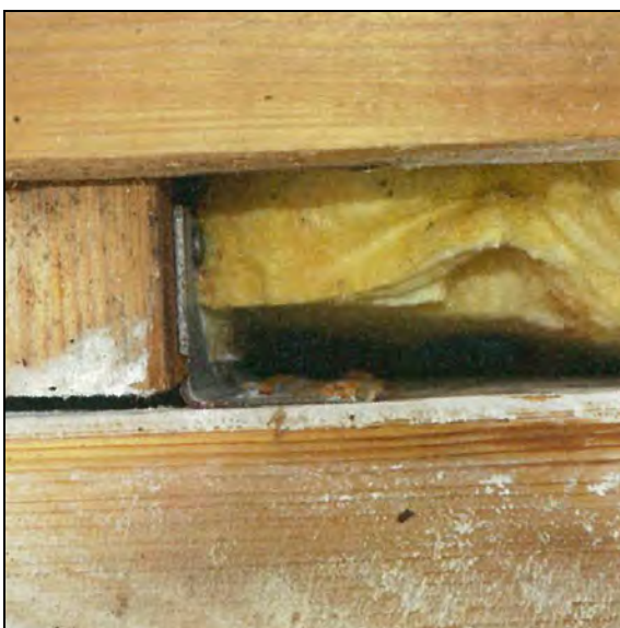
Abb. 19: Lücke zwischen Sparren und Wärmedämmung ermöglicht Konvektionsströmungen
