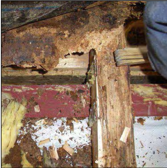
Abb. 36: Vollständig zerstörte Dachschalung
