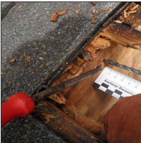
Abb. 25: Die Festigkeit der Holzsparren ist oberseitig aufgrund der ständig einwirkenden Feuchtigkeit stark beeinträchtigt
