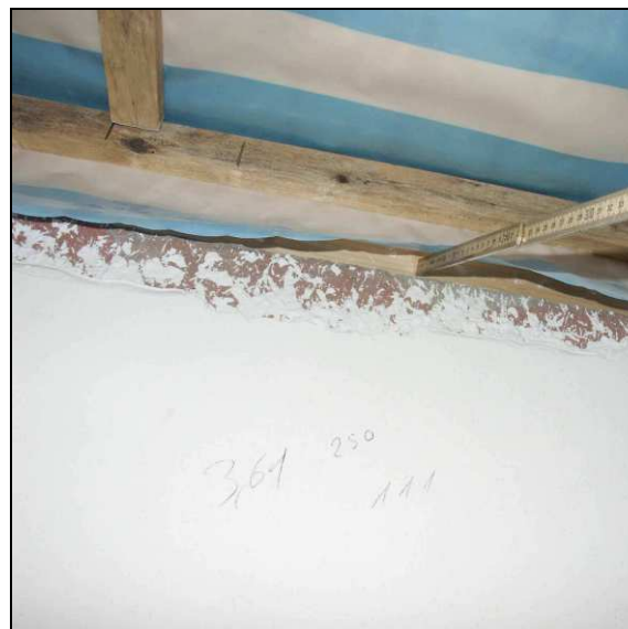
Abb. 18: Keine Verbindung der Dampfsperre zu verputzter Mauerwerksfläche (Außenwand)
