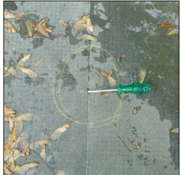
Abb. 31: Fehlstelle in der Abdichtungsnaht
