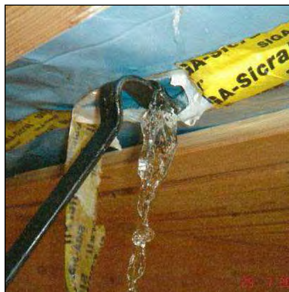
Abb. 20: Stehendes Wasser auf der Oberseite der Dampfsperre
