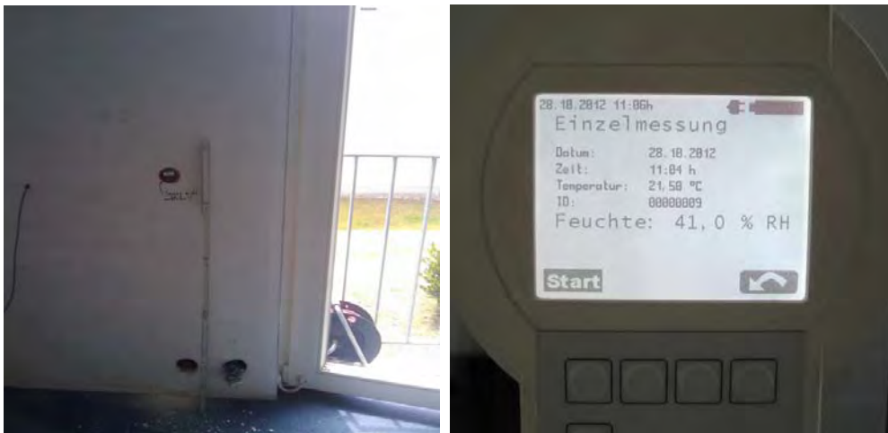
Bild 79: Anwendung der RFID-Feuchtesensor-Transponder an Außenbauteilen im Demonstrationsgebäude inHaus-1 (links) und Messwerte am Display des LF-Readers (rechts).
