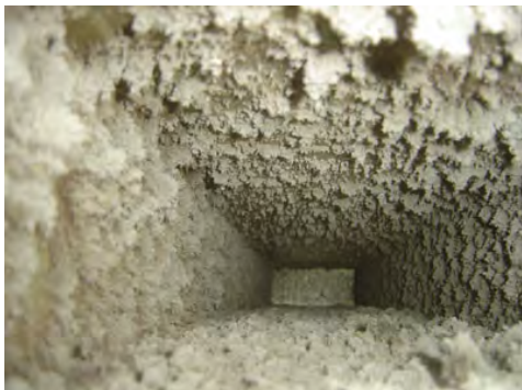
Bild 57: Beispiel eines verschmutzten Luftkanals 35
