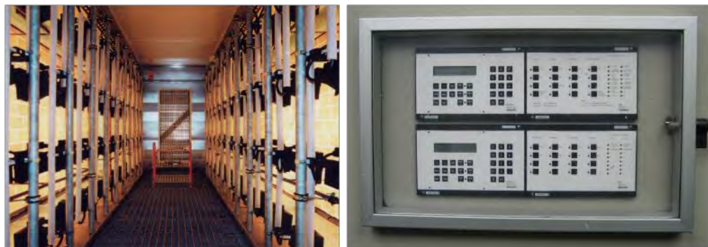
Abbildung 8-8: Außenklimakammer des Fassadenprüfstandes / DDC des Fassadenprüfstandes
