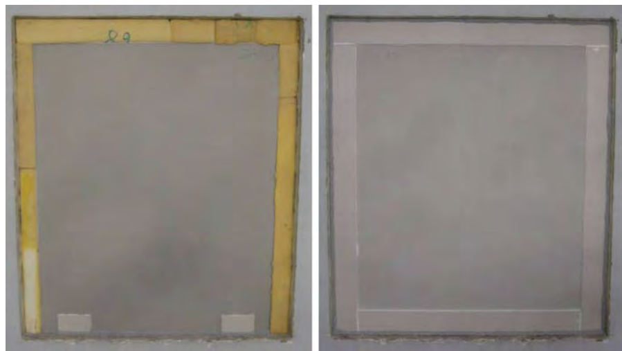
Abb. 16 Einbauöffnung des Fensterprüfstands während der Montage eines Prüfobjekts (vom Senderraum her gesehen).
