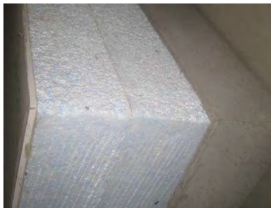
Abb. 21: Wärmedämm-Verbundsystem mit 200 mm Dämmstoffdicke auf einer Stahlbetonplatte (Seitenansicht). Die Dämmschicht bestand aus zwei aufeinander
