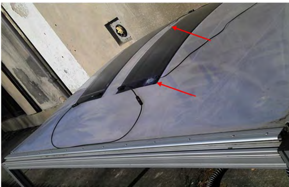
Bild 51 Temperatursensoren auf und neben den außenliegenden PV-Modulen.
