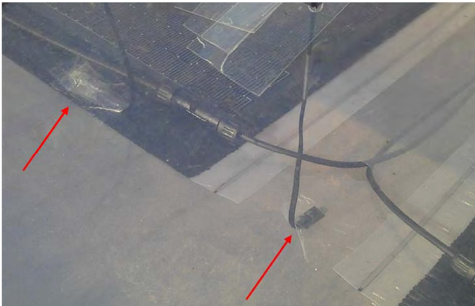
Bild 50 Temperatursensoren auf und neben den innenliegenden PV-Modulen.
