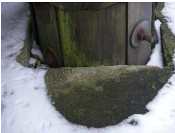
Abb. 30: Stützenfuß „versinkt“ im Betonsockel (10).
