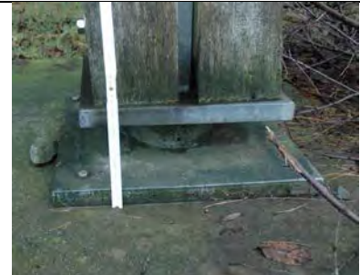
Stützenfuß breiter als Holz – Feuchteaufstieg im Hirnholz
