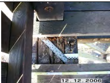
Kanzel-Deckenbalken Geschädigt durch Pilz Holzfeuchten > 30 %. Vereinzelt bis 80 %
