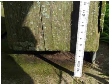
Stützenfuß – nur wenige cm Abstand, Flechtenbewuchs
