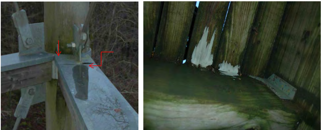
Abb. 23: Blechabdeckung mit offenen Fugen. Abb. 22: Durchfeuchtung und Pilzschaden.
