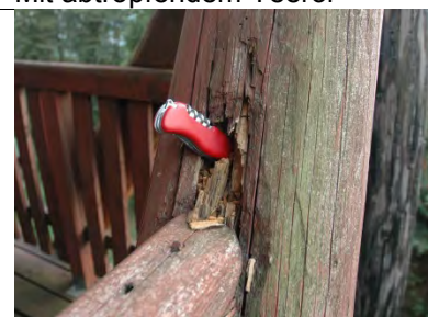
Messerklinge kann in das zerstörte Holz der Strebe tief eingeführt werden.
