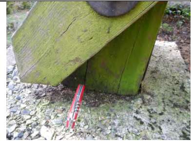
Stützenfuß NO Ecke Messer Klinge dringt ein.
