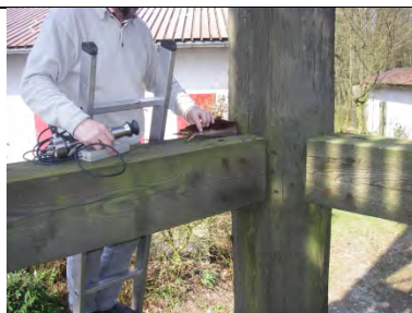
Knotenpunkt Nord-Stütze: Holz zerstört
