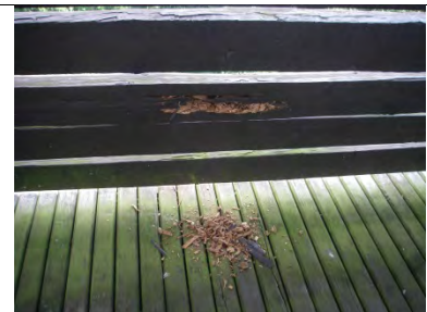
Brüstungsbekleidung ist an zumindest an einer Stelle von Holz zerstörendem Pilz befallen.
