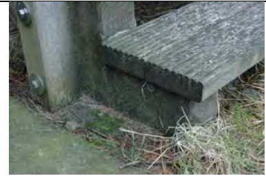
Treppenholz hat Erdkontakt – potentielle Schadstelle
