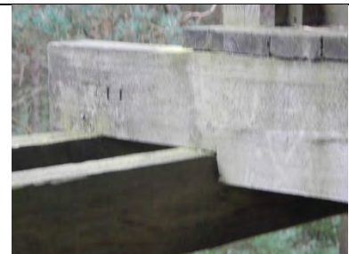
Ausgeklinkter Balken ohne Querzugsicherung
