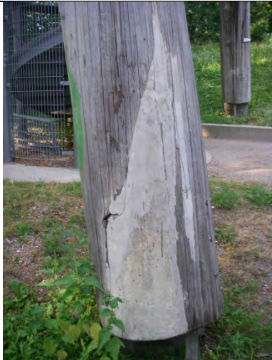
Mehrere Stellen sind – augenscheinlich nachträglich - mit einem Mörtel geschlossen worden. Der Mörtel ist vom Holz wieder abgerissen
