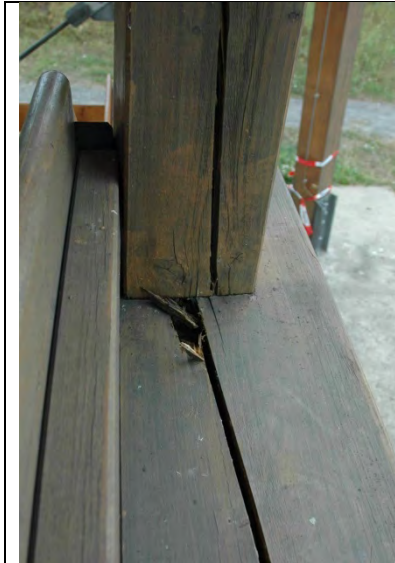
Schadstelle Riegel - Zwischenstütze
