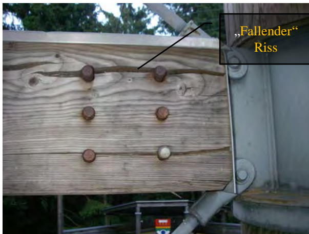
Abb. 28: Trockenriss im Bereich eines Stabdübelanschlusses (61).
