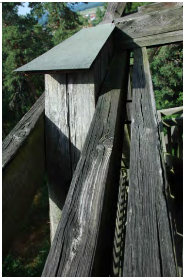
Horizontale Zangen mit Strebenanschluss. Nur der direkte Anschlussbereich ist abgedeckt. Zangen oben intensiv gerissen.
