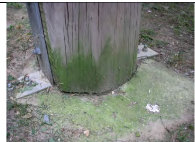
Stützenfuß und Fundament mit Algenbewuchs
