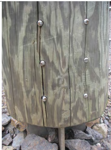
Stützenfuß Trockenrisse befinden sich in der Risslinie der Stabdübel
