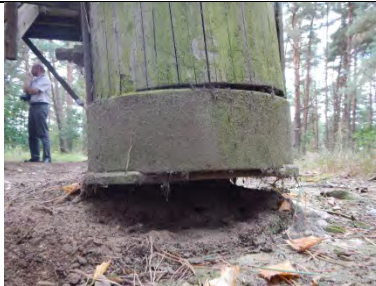
Stützenfuß Abstand zu Boden \leq 5 cm Bei Bild wurde Erde unter Fuß beseitigt. Holzstütze wird von Stahlring umfasst und ruht unten auf Stahl.
