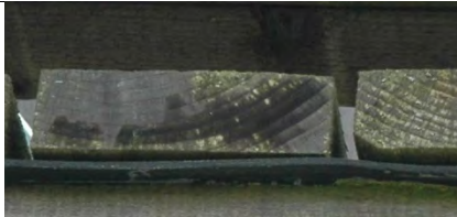
Zwischen Podestbelag und Balken wurde eine Sperrpappe angeordnet, die seitlich übersteht.
