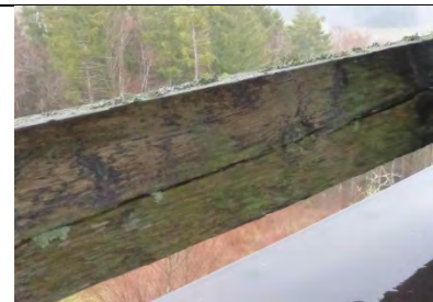
Flechtenbewuchs auf äußeren, gerissenen Geländerbalken.
