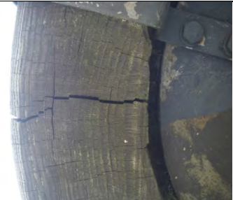
Unteransicht Stützenfuß mit starker Rissbildung
