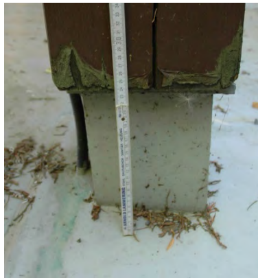
Stützenfuß außen Holz durch Pilz geschädigt
