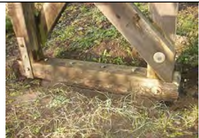
Schwelle ohne Spritzwasser- Abstand
