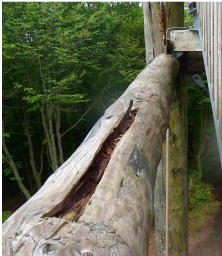
Abb. 12: Geschädigter, im Jahre 2000 verbauter Rundholzriegel (Turm Nr. 36).
