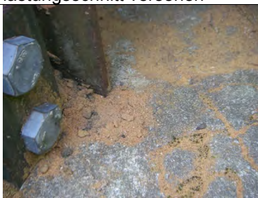
Holzmehl auf Betonsockel = Ameisenfraßmehl
