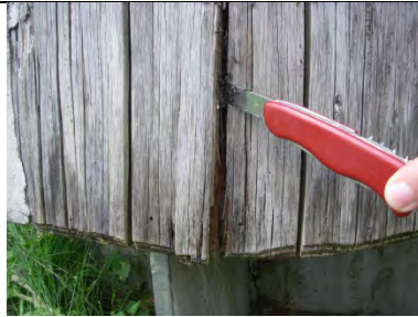
Beim Abklopfen der Stämme klingen diese hohl. Mit der Messerklinge lässt sich die äußere, intakt erscheinende Schicht leicht abhebeln. Dahinter steht vermulmte Substanz an.
