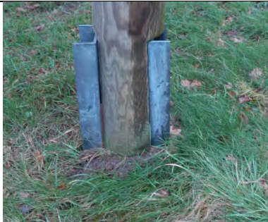
Stützenfuß Holz reicht bis ins Erdreich
