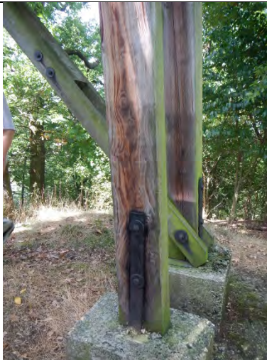
Stützen- und Strebenfuß Gleichfalls ohne Abstand zum Sockel
