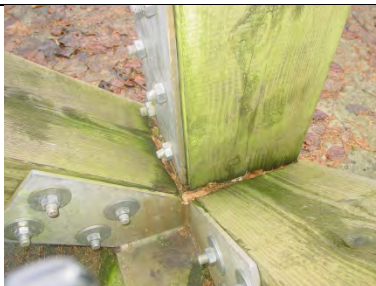
„Wassernester“ im Anschluss Streben an Stütze
