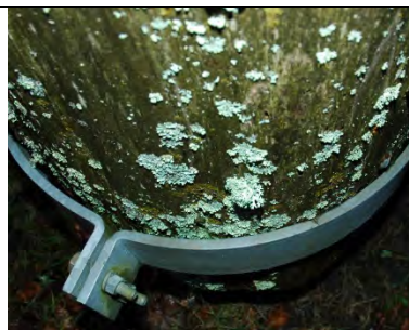
Flechtenbewuchs auf Rundholz- stützen behindert Wasserabfluss
