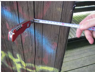
Eine tiefe Delaminierungsfuge ist auf beiden Seiten der BSH-Stütze zu erkennen. Sie geht anscheinend durch die ganze Stütze durch.
