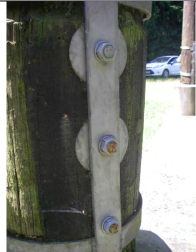
Anschluss Stütze an Fundament Dübel nicht durch Lasche abgedeckt
