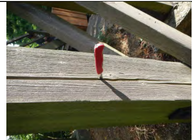
Tiefer horizontaler Riegel Mit Riss Ohne Abdeckung
