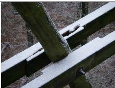
Knotenpunkt Doppelzange mit Rundholzstrebe Schaden an äußerer Zange durch Holz zerstörenden Pilz
