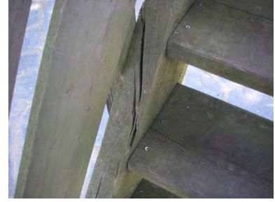
Treppenwange mit Bruch durch Schrägfaserigkeit
