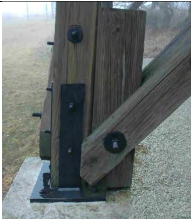
Stützenfuß Oberfläche Betonsockel wirkt Spritzwasser widerkehrend
