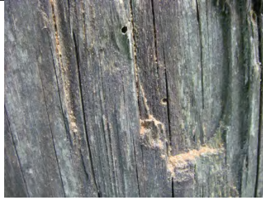
Aus Rissen und Ausfluglöchern von Holz zerstörenden Insekten rieselt Holzmehl heraus.
