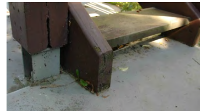
Stützenfuß, innen, mit Abstand zur Gründung Treppenantritt ohne Abstand zur Gründung
