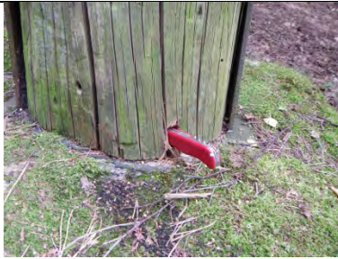
Stützenfuß Ohne Abstand zum Boden Geschädigt durch Pilz
