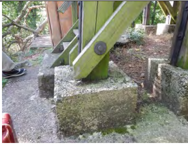
Stützenfuß Dieser Stützenfuß wurde angebohrt. Das Bohrmehl außen war hell, drinnen verfärbte es sich braun → Hinweis auf Befall mit Holz zerstörenden Pilzen. Anklopfen ergab Hohlstellen
