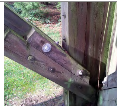
Strebenanschluss ohne baulichen Holzschutz
