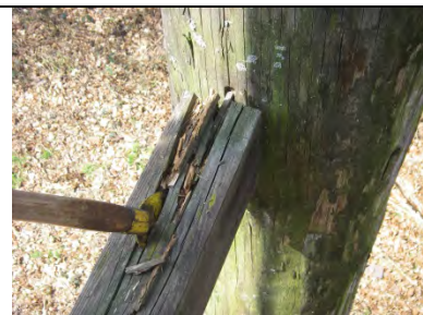
Anschluss Riegel an Rundholz- stütze Riegel durch Pilz zerstört.
