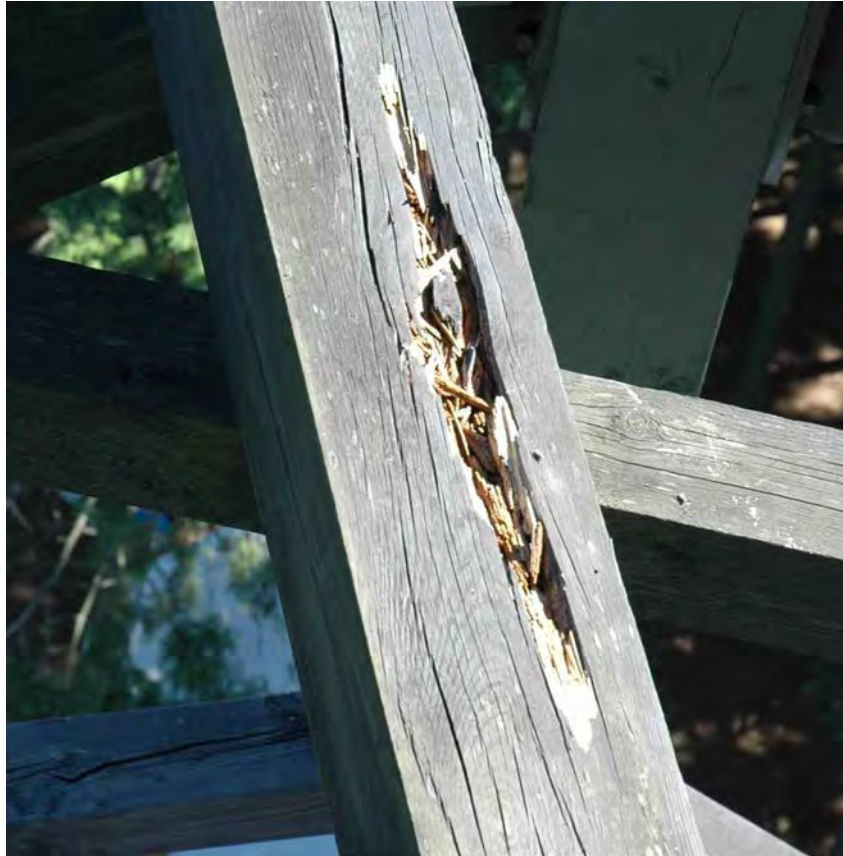
Abb. 13: Holzerstörung an einem kesseldruckimprägnierten Kiefernkantholz nach 12 Jahren (Turm 2).
