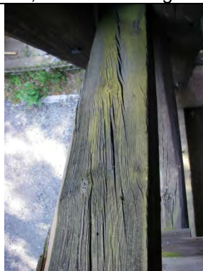
Aufsicht auf gerissene Strebe
