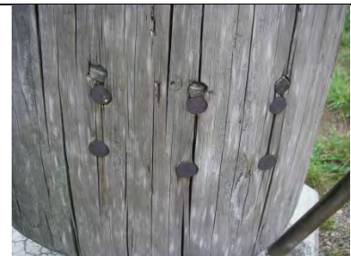
Risse liegen immer wieder in Achse der Stabdübel. Fehlbohrung wurde ausgedübelt
