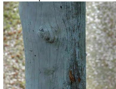
Stütze auch im oberen Bereich von Hausbock und Pilz befallen
