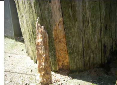
Schädigung durch Pilzbefall am Stützenfuß
