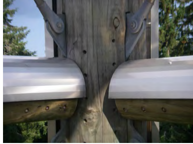
Horizontale Riegel wurden nachträglich abgedeckt. Die vertikale SW-Eckstütze wurde gleichfalls bekleidet.
