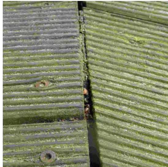
Abb. 15: Schmutzablagerungen in Stoßfuge – unterhalb ist der imprägnierte Balken von Pilzen befallen.
