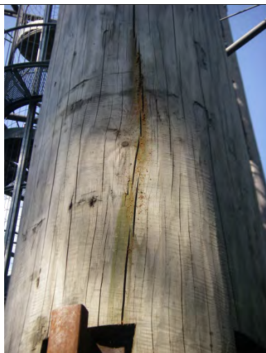
Aus Trockenriss rieselt Holz- mehl, von Ameisen verursacht
