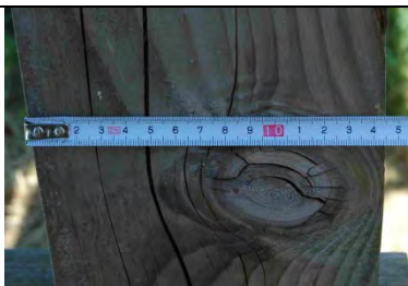
Risse um Aststelle, Faserabweichung
