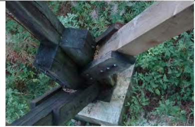
Strebenanschluss an Stützenfuß mit Holzlaschen Schmutz und Feuchtigkeit sammeln sich im Anschlussbereich Hirnholz der Knaggen nicht abgeschragt, nicht abgedeckt.
