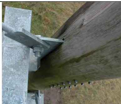
Anschluss mit Verfärb. am Holz
