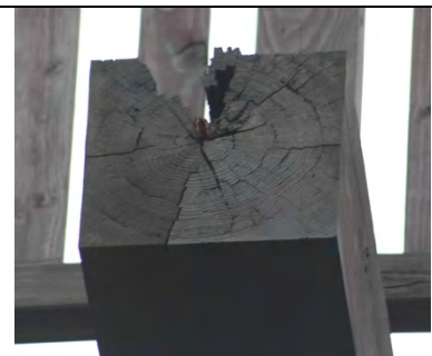
Hirnholz Podestbalken Mit Schädigung durch Pilzbefall
