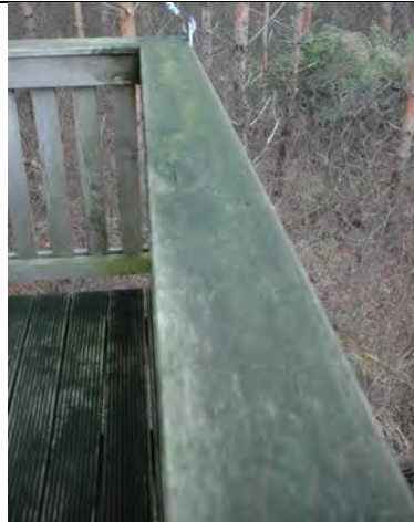
Bewuchs an Geländer und Boden
