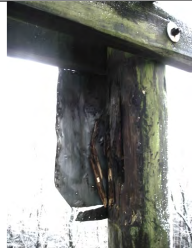
Anschluss Schnittholz-Riegel Rundholzstütze geschädigt, provisorisch mit Blech abge- deckt
