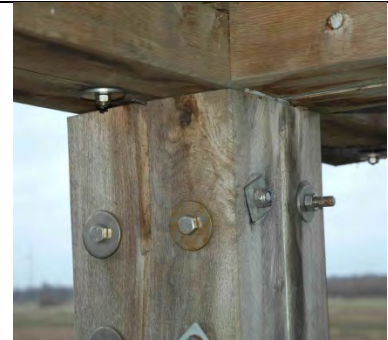
Stützenkopf – größtenteils durch Riegel abgedeckt, Eindringen von Wasser aber nicht ausgeschlossen
