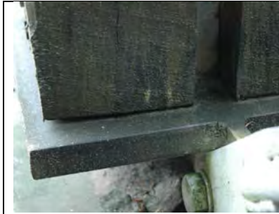
An der Stütze ablaufendes Wasser sammelt sich auf der Stahlplatte und zieht ins Hirnholz – potentielle Schadstelle
