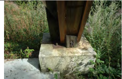
Stützenfuß ohne Abstand auf Betonsockel Schädigung durch Pilz
