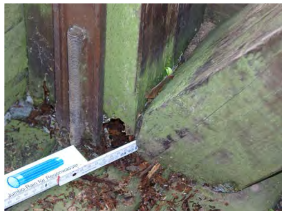
Abb. 31: Geschädigte Stützen und Streben im Bereich des Zwischenpodestes (30).
