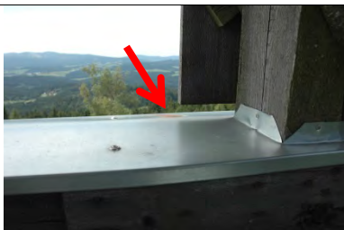
Zinkblechabdeckung mit Korrosionsfleck Anschluss Blech-Stütze nicht regendicht
