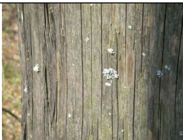
Rundholzstütze intensiv geris- sen Flechtenbewuchs
