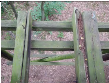
„kariös“ geschädigter Podestbalken
