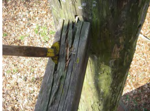
Abb. 33: geschädigter Riegelanschluss an Stütze.
