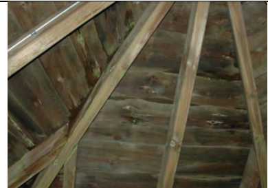
Dach – Unterseite - feucht Das Dach ist offenbar mit Bret-tern ohne Abklebung einge-deckt.
