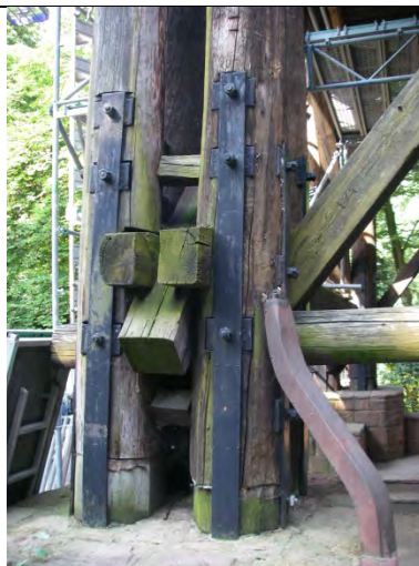
Stützenfuß Zwischen Beton und Stütze wurde ein Klotz zwischengeord- net, der mit Blei abgedeckt ist.
