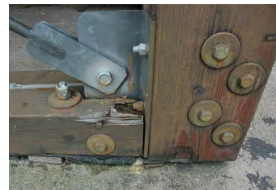
Stützenfuß (Innenstütze) 0 cm Abstand zwischen Grün- dung und Unterkante Schwelle und Stütze Fäule an Schwellenende
