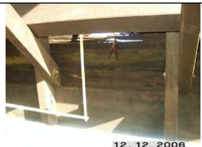
Dachschalung durch Holz zer- störenden Pilz zerstört. Dadurch gelangt Wasser auf Kanzel- Belag und Kanzel- Deckenbalken
