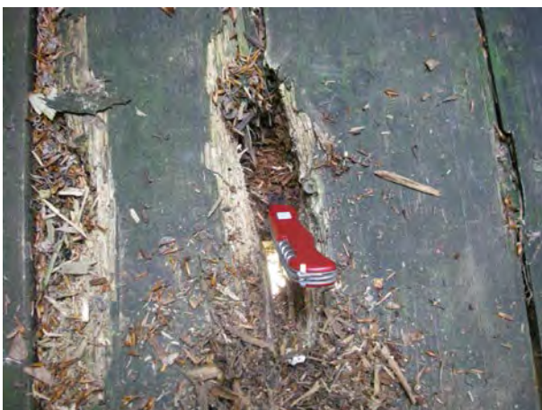
Abb. 26: Schmutzkegel und Zerstörung von Belag und Balken (58).
