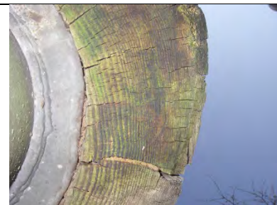
Stützenfuß Stahl-Auflager in Stamm eingelassen Risse reichen tief ins Holz
