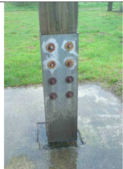
Fußpunkt Korrosion an Bolzen und Unter-lagscheiben
