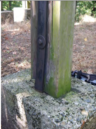
Treppen-Stütze Ohne Abstand zwischen Sockel und Stütze
