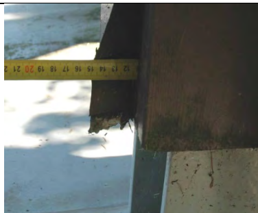
Stütze pilzgeschädigt. Maßstab kann 11 cm tief in die Stütze eingeführt werden.
