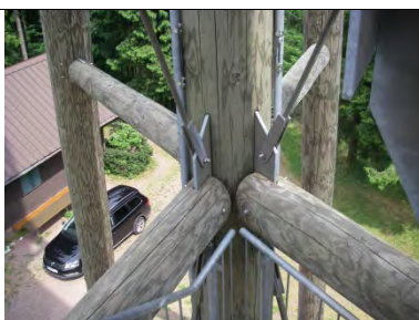
Anschlussknoten mit eingeschlitzten Stahlblechen Horizontale Riegel sind nicht abgedeckt
