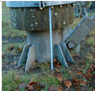
Stützenfuß Mit Flechtenbewuchs
