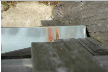
Korrosion durch Wasserablauf an Zinkblechabdeckung Anschluss Blech-Stütze nicht regendicht
