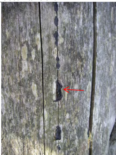
Fruchtkörper „Leiste“ eines Holz zerstörenden Pilzes an Stütze
