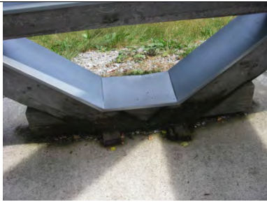
Strebenaufleger auf Gründung ohne Spritzwasserschutz Schwelle durchfeuchtet Klötze aus Eiche
