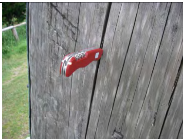
Stützen sind intensiv gerissen. Messerklinge lässt sich ohne Mühe bis zum Heft in die Risse einführen.
