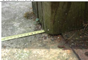
Stützenfuß auf Betongrundplatte ohne Abstand Schädigung durch Pilze
