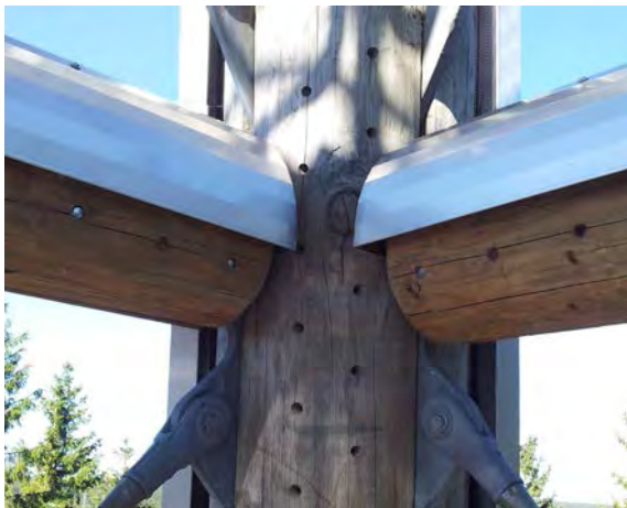
Abb. 38: Abdeckung der neuen Riegel (59) und der Eckstütze.
