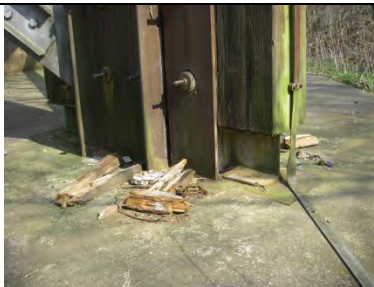
Stützenfuß 18 cm über Betonfundament Zerstörte Holzteile auf Beton
