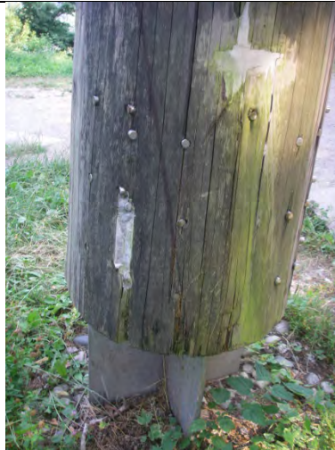
Stützenfuß Die Stützen sind gerissen. Teil- weise laufen die Risse in der Risslinie der Stabdübel. Fehlstellen im Holz sind mit Mörtel geschlossen worden.
