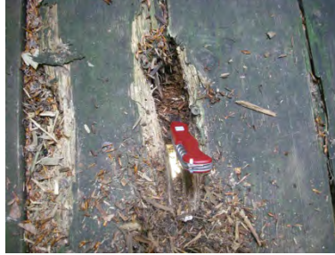
Podestbelag auf zwei Ebenen durch Holz zerstörende Pilze geschädigt. Die Messerklinge lässt sich in den tragenden Podestbalken ohne Anstrengung tief einführen. Eine Schadstelle wurde schon provisorisch abgedeckt.
