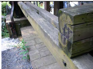
Waagerechte Hölzer ohne Ab- deckung
