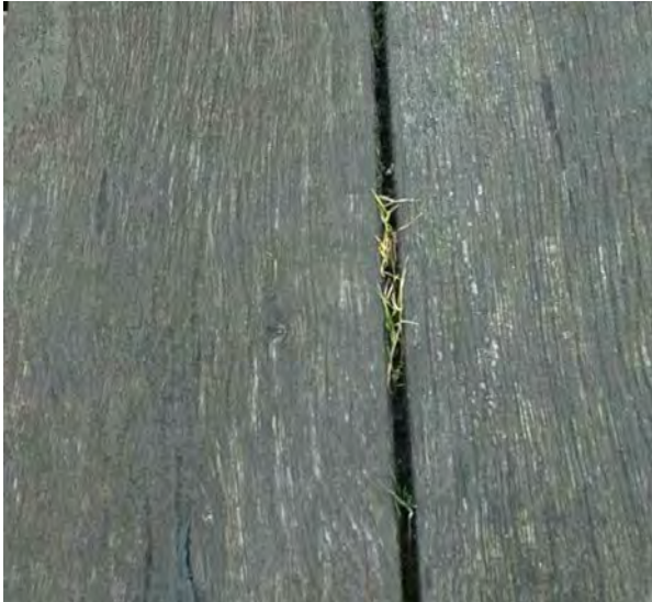
Abb. 14: Schmutzablagerungen und Bewuchs in den Fugen der Belagshölzer.
