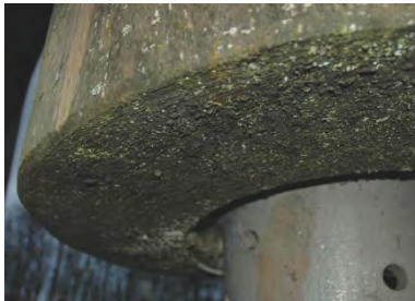
Feuchte und Bewuchs am Hirnholz des Stützenfußes
