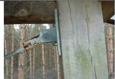
Korrosion an Zugbändern
