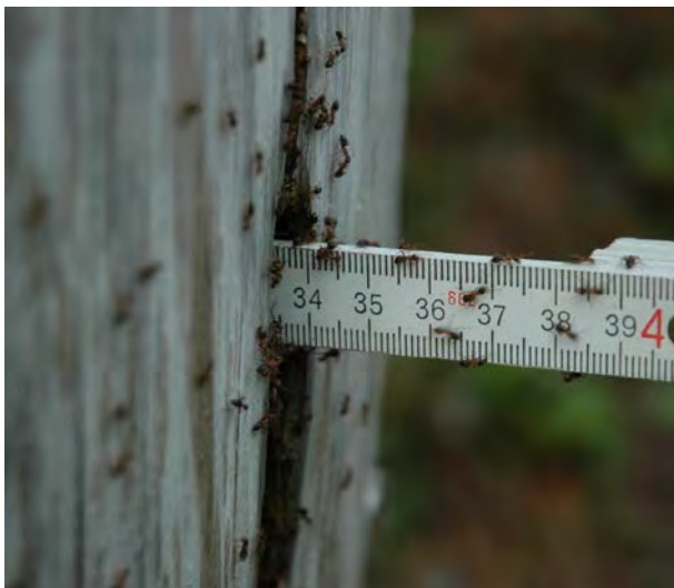
Abb. 24: Trockenriss in Stütze (Turm 54) über 33 cm tief, Kern durch Pilze geschädigt und von Ameisen besiedelt.
