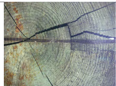
Unteransicht Stützenfuß mit durchgehenden Trockenrissen Rechts (heller Fleck): Entlas- tungsnut ca. 5 cm tief Eine Kerbe an der Unterseite hat keinen Einfluss auf die Rissbildung.
