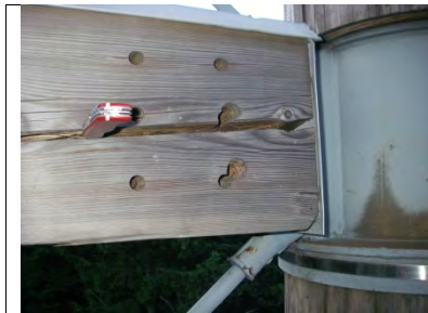
Stoß- und Anschlussstelle Risse in den horizontalen Riegeln Flugrost an verzinktem Stahlteil
