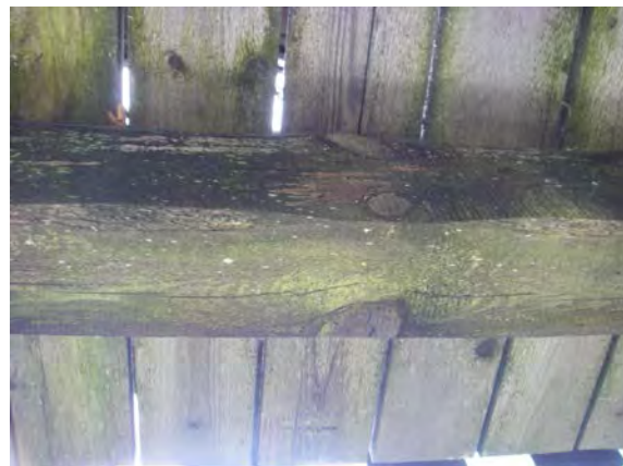
Abb. 35: Sperrpappe deckt Balken oben ab. Balken ist intensiv befeuchtet (62).
