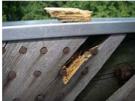
Abb. 37: Blechabdeckung mit geringem seitlichen Überstand und Schädigung des Diagonalstabanschlusses (62).
