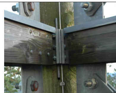
Knotenpunkt Intensive Befeuchtung trotz Blechabdeckung
