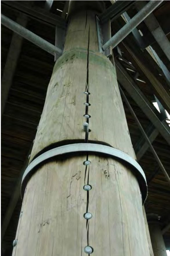
Abb. 29: Trockenriss in Rundholzstütze (53).
