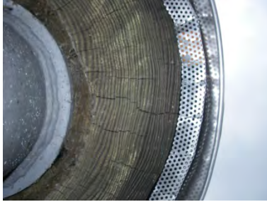
SW-Eckstütze mit Bekleidung Tiefe Risse
