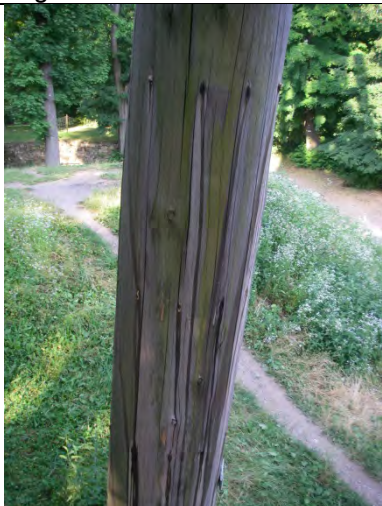
Augenscheinlich nachträglich wurden die Stämme angebohrt und mit Holzschutzmittel getränkt.
