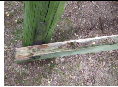
Strebe geschädigt durch Pilz
