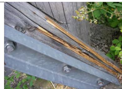
Holz der Strebe durch Pilz geschädigt
