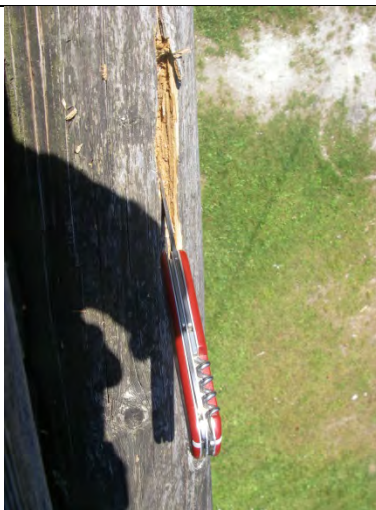
Pilzbefall an Stütze
