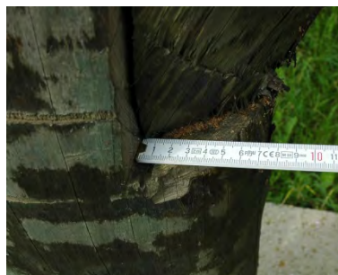
Bild 5 Strebenanschluss Konstruktiv mangelhaft, da „Wassersack“
