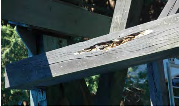
Abb. 27: Oberseitiger Riss mit Schadstelle im Riegel (02).
