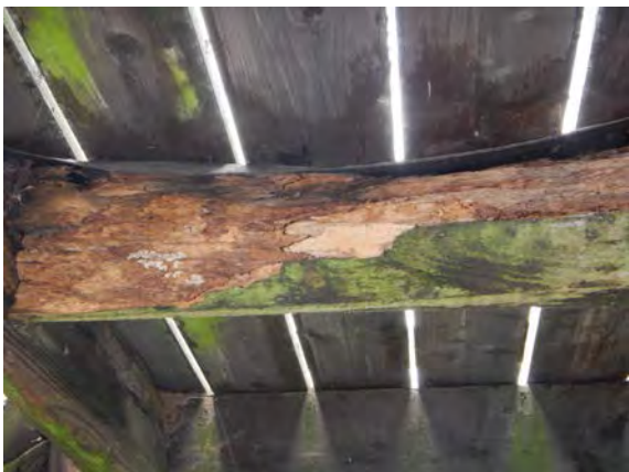
Abb. 34: Sperrpappe deckt geschädigten Balken oben ab (11).
