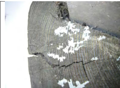
An der Unterseite der Stützen- füße sind tiefe Risse erkennbar.
