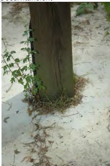
Stützenfuß auf Betongrundplat- te ohne Abstand
