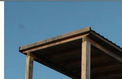
Stützenköpfe sind durch Dach- balken und Dach abgedeckt, jedoch ohne 60°-Schutz
