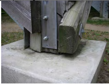
Stützenfuß Auf Betonsockel, fast ohne Ab- stand
