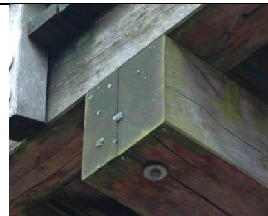
Riegelkopf – offenbar feucht, da Flechtenwuchs
