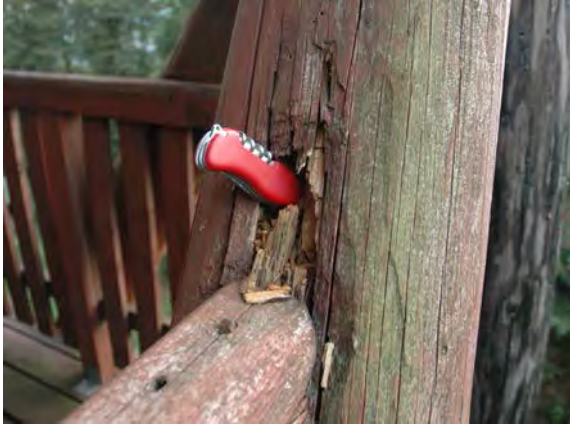
Abb. 32: Geschädigter Knotenpunkt Brüstungsriegel – Strebe (31).
