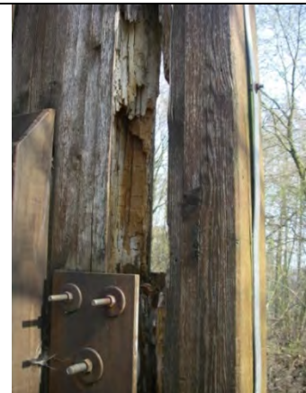
Schadstelle im Bereich Funda- menteinspannung
