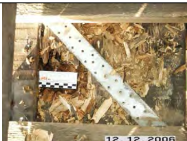
Kanzel-Deckenbalken Geschädigt durch Pilze
