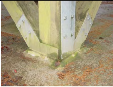
Stützenfuß außen Ohne Spritzwasserschutz direkt auf Gründung
