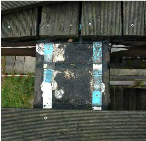
Abb. 20: Balkenabdeckung mit Leisten und Längsstoß (17).
