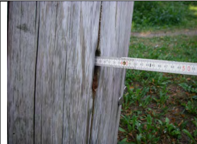
An einer Fehlstelle (Specht- loch?) kann der Maßstab 34 cm tief in den Stamm eingeführt werden.
