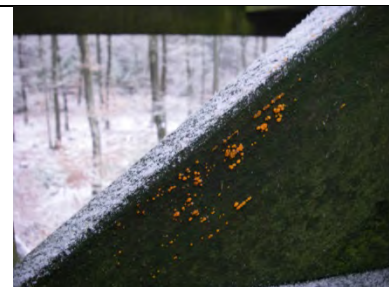
Treppenwange Befall mit Gallerträne
