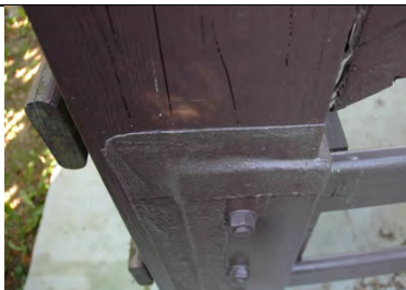
Fuge zwischen Holzstütze und Stahlfuß wurde (nachträglich) abgeklebt.
