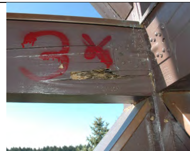
Riegel pilzgeschädigt. verzinkter verstärkter Winkel- verbinder
