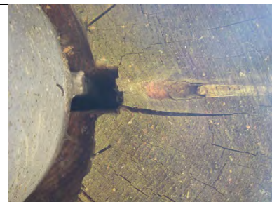
Stützenfuß Stahlauflegerplatte in Stütze eingelassen Tiefe Risse
