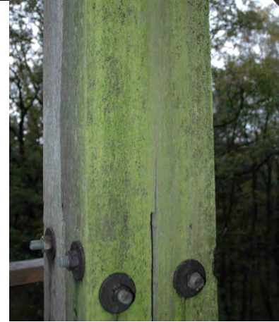
Stütze mit Bewuchs Rost an Bolzen und Unterlag- scheiben
