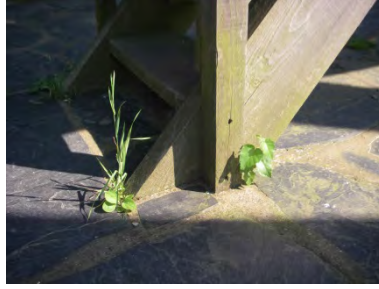
Treppenwange liegt direkt auf Boden
