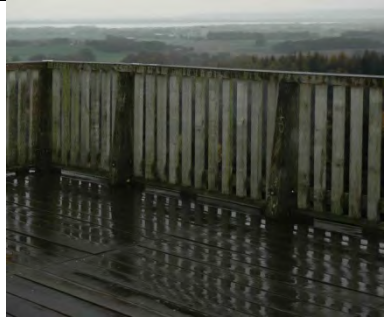
Bewitterte Plattform - Feuchte
