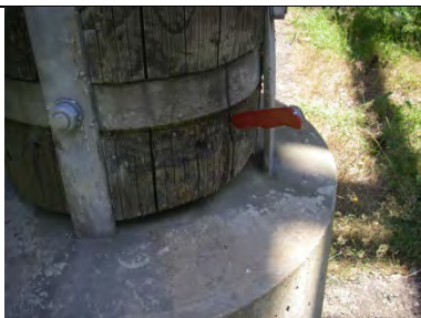
Pilzbefall an Stützenfüßen
