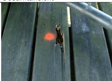
Schadstelle im Podestbelag
