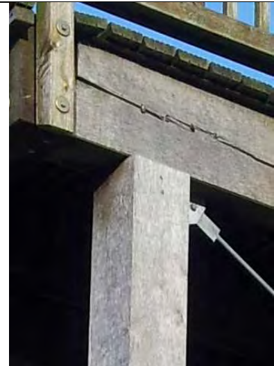
Stützenkopf Riss in Stabdübelachse
