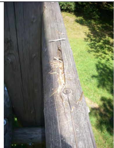
Pilzbefall an Riegel
