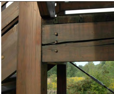
Anschluss Innenstütze – Podo- striegel Gerissene Riegel
