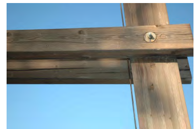
Zangenholz gerissen, ohne Luftspalt zur Stütze und Strebe
