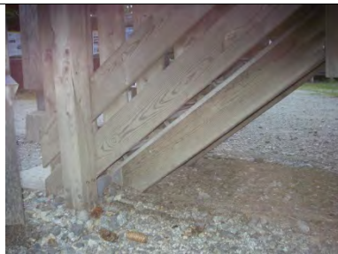
Die Treppe lagert direkt auf Bodenbelag auf.
