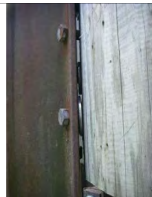
Stützen sind mit je 2 Dübel besonderer Bauart oben und unten an Eisenbahnschienen befestigt. Dazwischen wurden Holzschrauben ohne Dübel angeordnet.
