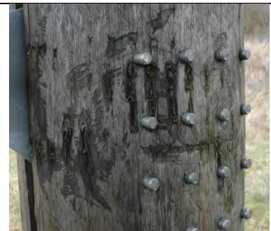
Im Bereich eines Anschlusses ist die Holzoberfläche geschädigt.
