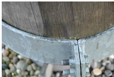
Der Metallring am Stützenfuß behindert den Wasserabfluss
