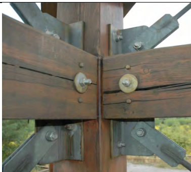
Knotenpunkt Gerissene Riegel
