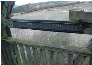
Riegelverstärkung mit Stahl nach Feuerschaden
