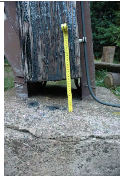
Stützen-Fuß Mit abtropfendem Teeröl
