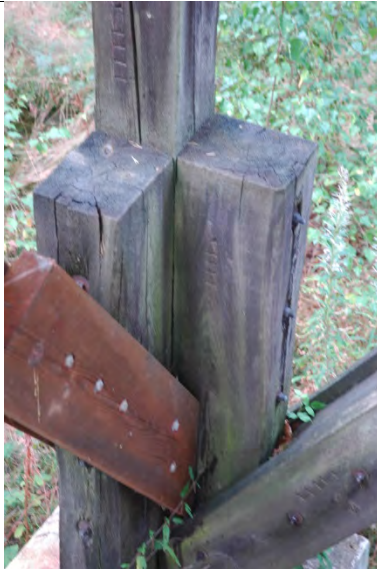
Strebenanschluss Laschen erneuert
