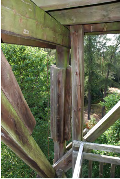
Stützenstoß mit Kanthölzern Grünalgenbewuchs
