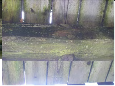
Abdeckung eines Podestbalkens steht nicht über. Abfließendes Wasser befeuchtet den Balken. Die Holzoberfläche ist weich, faserig. Die Messerklinge lässt sich einige mm tief leicht eindrücken.
