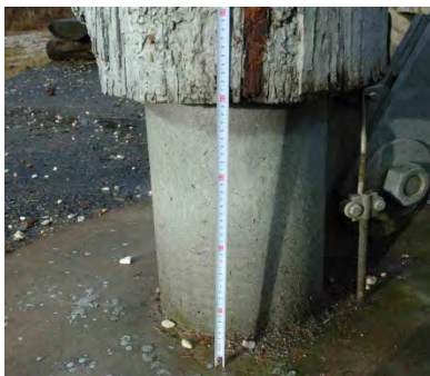
Stützenfuß mit Pilzbefall
