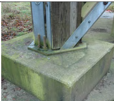
Stützenfuß – Sockel Holz im Spritzwasserbereich
