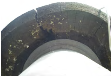
Stützenfuß zeigt breite, tiefe Risse
