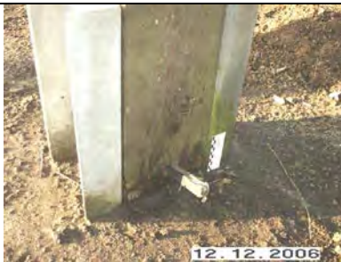
Stützenfuß Geschädigt durch Pilz Messerklänge kann 8 cm tief eingedrückt werden
