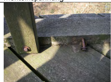
Podestbeläge + Treppen aus Azobé Keine Schäden erkennbar Schwelle Umwehung direkt auf Belag Horizontale Balken nicht abge- deckt
