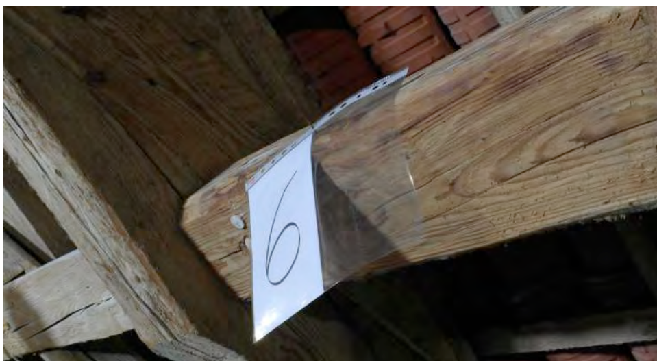
Abb. 38 Naumburg, Dom, Feld 6, Zustand nach Alkydharzbeschichtung (11.3.2014)
