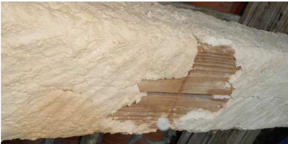
Abb. 41 Naumburg, Dom; Feld 2 Zustand nach Kompressenentsalzung (11.3.2014)
