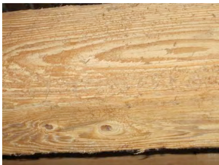
Abb. 16 Wechselburg, Klosterkirche: Mazeration nach Reinigung
