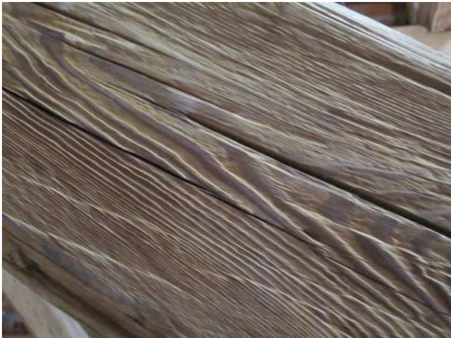
Abb. 14 Meißen, Albrechtsburg (Nordseite): Waschbretteffekt nach Reinigung im Strahlverfahren
