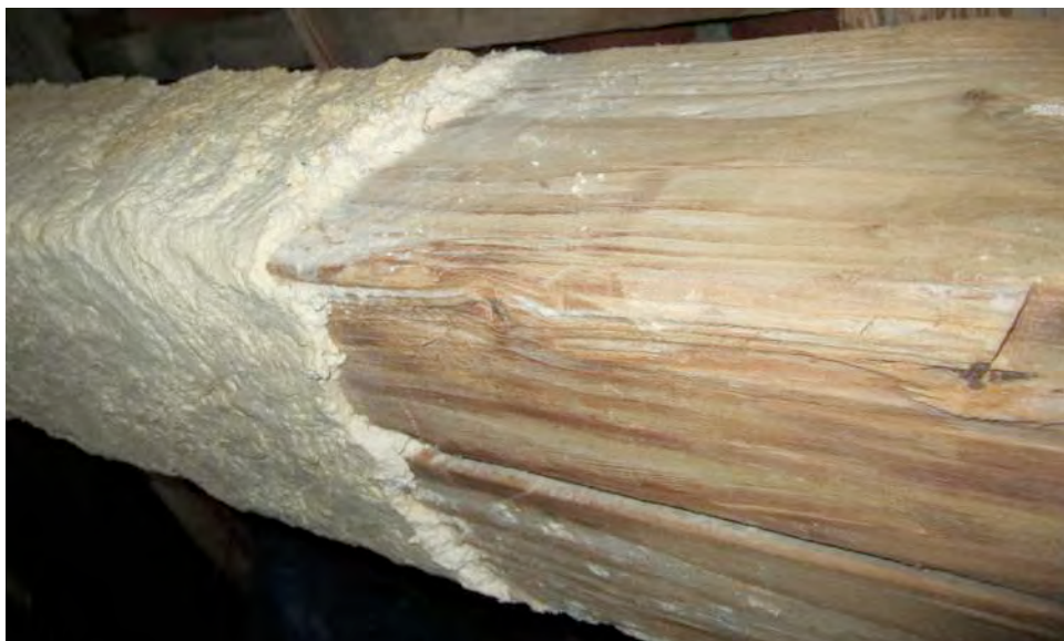
Abb. 42 Naumburg, Dom, Feld 1 Zustand nach Kompressenentsalzung (13.6.2013)
