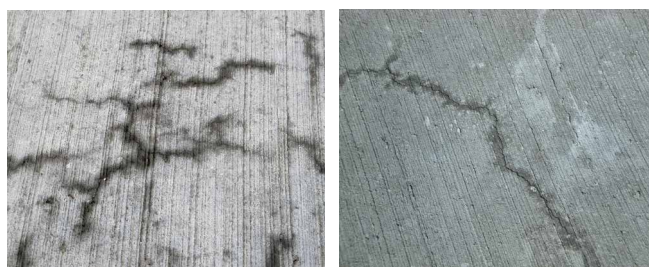
Abb. 5 a und b: Fröhschwindrissbildungen auf den Parkflächen (Aufnahmen nach dem Bewässern der Risse)
