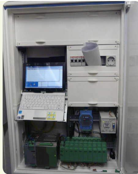
Abb. 4-6: Details der Sensoren (Wärmemengenzähler, links) und der Daten-Logging-Station (rechts)
