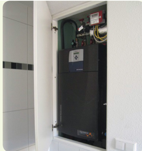
Abb. 4-4: Frischwasserstation zur Bereitstellung von Trinkwarmwasser
