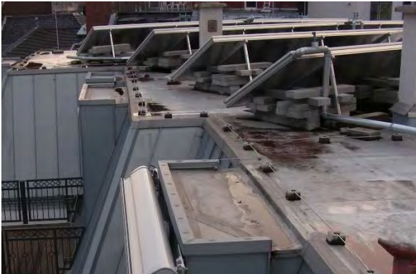
Abb. 62 Übersicht zur Einbausituation der Solarthermie-Elemente auf der Dachfläche eines Mehrfamilienhauses
