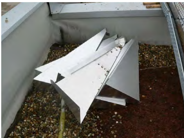
Abb. 10 Zwischenlagerung von Metallbauteilen am Dachrand.
