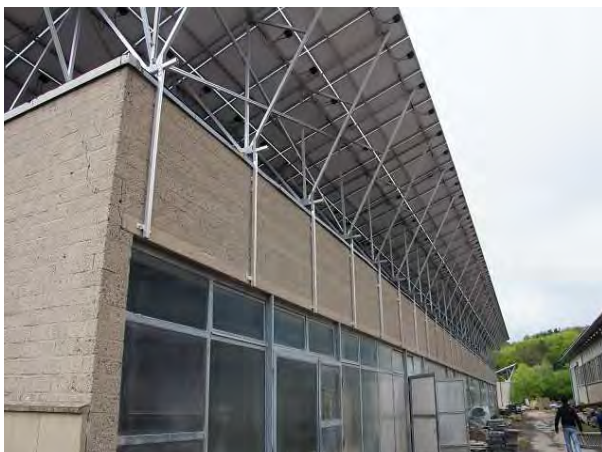
Abb. 22 Großflächige PV-Anlage über dem Flachdach einer Produktionshalle
