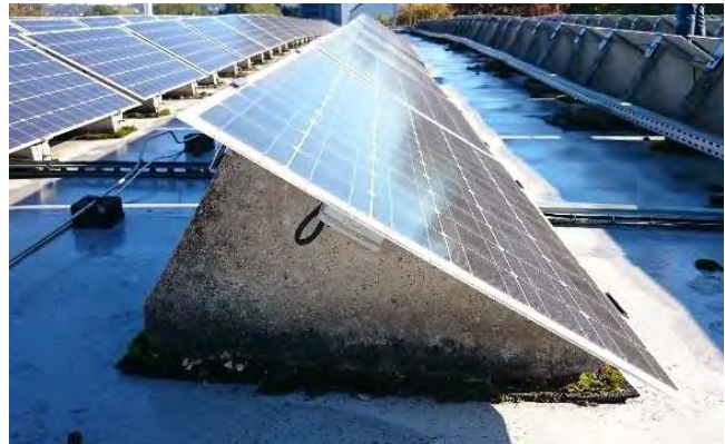
Abb. 86 Betonaufleger auf Bautenschutzmatte über Kunststoffdachbahn mit starker Vermoosung, aber schadensfreier Standzeit
