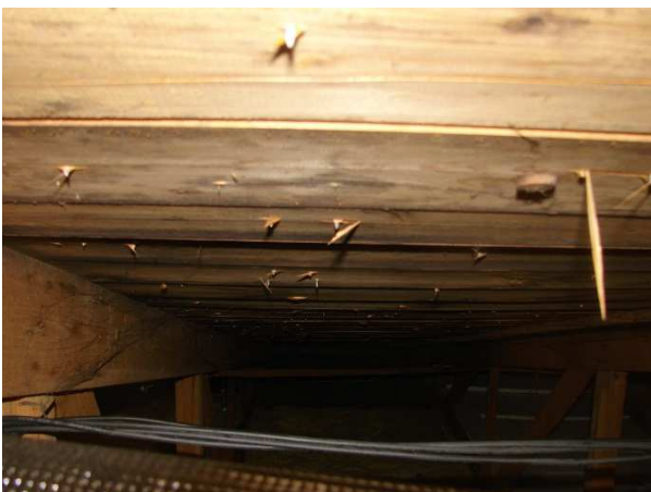
Abb. 28 Holzschrauben durchdringen die Schalung über dem Hinterlüftungsraum und führen zu Abtropfungen in die Dachkonstruktion.
