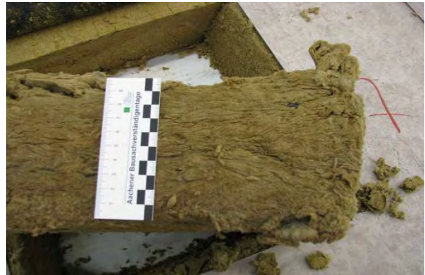
Abb. 41 Durchfeuchtete und dickenverminderte Mineralwollgedämmung
