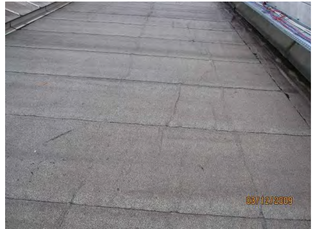
Abb. 13 Zustand der Dachabdichtung vor der Montage
