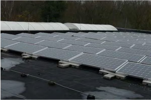
Abb. 89 Übersicht zu der auf Betonfertigteilstreifen montierten PV-Anlage
