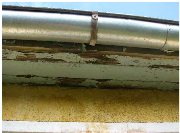
Abb. 29 Durchfeuchtete Verschalung des Traufbereichs
