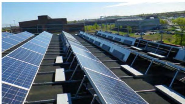
Abb. 44 Entfernte Windableitbleche haben das Windsogverhalten der PV-Anlagen verändert. [Quelle: www.dgs-berlin.de ]
