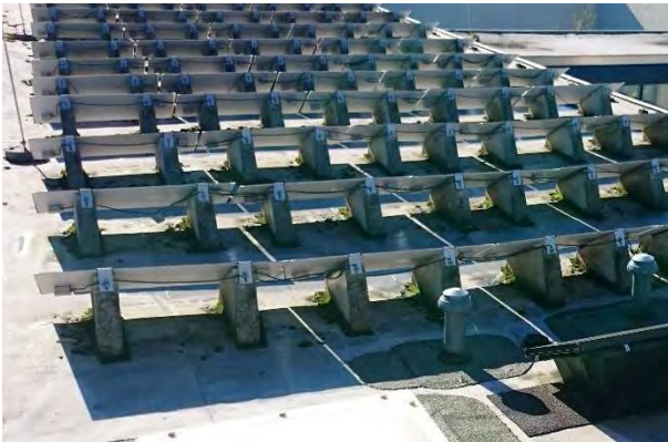
Abb. 85 PV-Anlage mit langer Standzeit und Betonauflagern
