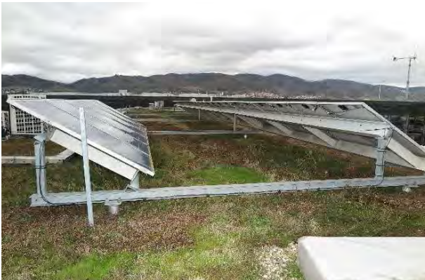
Abb. 70 Direkt befestigte Solaranlage auf einem extensiv begrünten Dach
