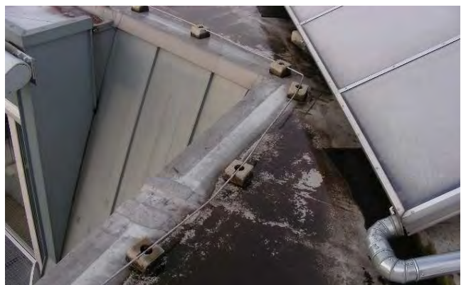
Abb. 65 Kein Abstand der Solarkollektoren zum freien Dachrand im Bereich einer innenliegenden Gebäudeecke
