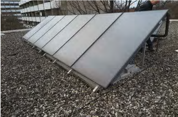
Abb. 91 Solarthermische Anlage auf bekiestem Umkehrdach
