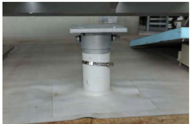
Abb. 73 Fachgerechte Eindichtung des Stützenfußes mit Kunststoffmanschette
