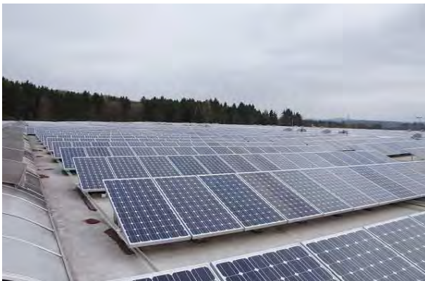
Abb. 34 Aufgeständerte, ballastierte PV-Anlage über Kunststoffdachbahn
