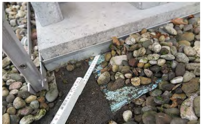
Abb. 94 Unter den Querprofilen mit den Ballastierungselementen ist ein geringer Luftspalt vorhanden.
