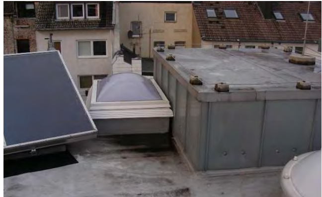
Abb. 63 Der Abstand zu aufgehenden Bauteilen (hier einer Lichtkuppel) ist sehr gering.
