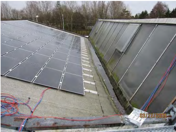
Abb. 12 Sheddachfläche mit PV-Modulen
