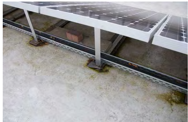
Abb. 35 Absenkungen der punktförmigen Auflager mit Wasseransammlungen
