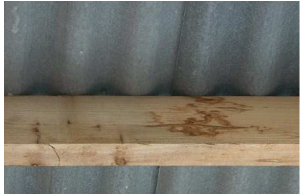
Abb. 69 Feuchtespuren an den Holzträgern des Bootshallendaches
