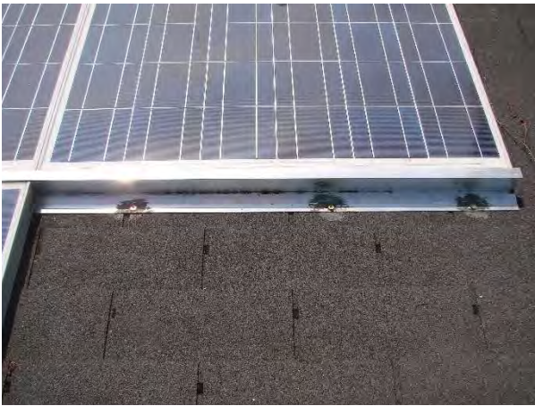
Abb. 26 Auflagerung der dachparallelen PV-Anlage unmittelbar auf der Abdichtung aus Bitumenschindeln
