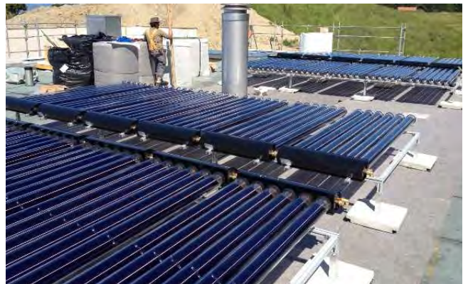
Abb. 88 Die Kollektoren liegen parallel zur Dachebene und wurden mit deutlichem Abstand von der Dachhaut angeordnet.
