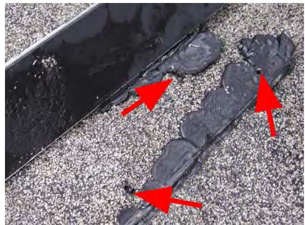
Abb. 15 Durchdringungen der Befestigungsschrauben (Pfeile) durch die Dachabdichtung sind nur teilweise und nur zufällig mit Bitumen „abgedichtet“.
