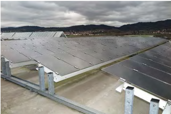
Abb. 74 Solaranlage mit direkter Befestigung über eingeklemmter Dachbahn
