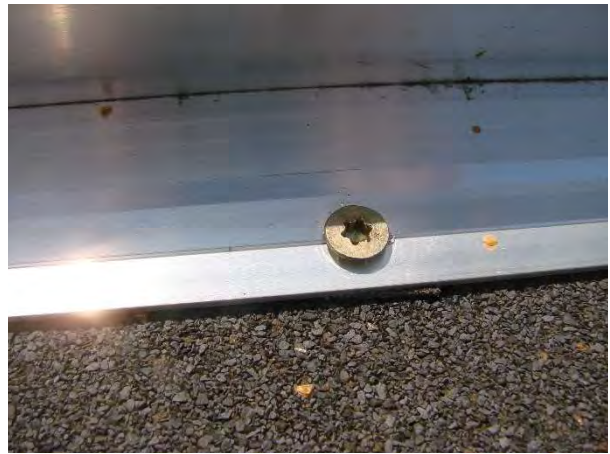
Abb. 27 Direkte Befestigung mittels nicht fachgerechter Verschraubung durch die Abdichtung
