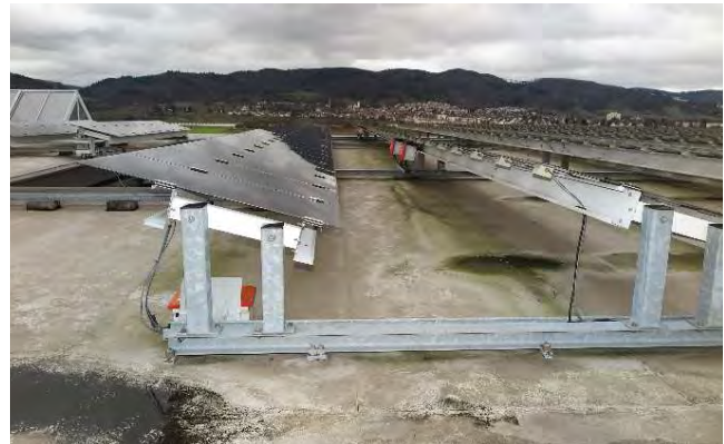
Abb. 75 Die Tragprofile der direkt befestigten Solaranlage weisen einen geringen Abstand zur Dachhaut auf. Ansonsten ist die Dachhaut frei zugänglich und wartbar.
