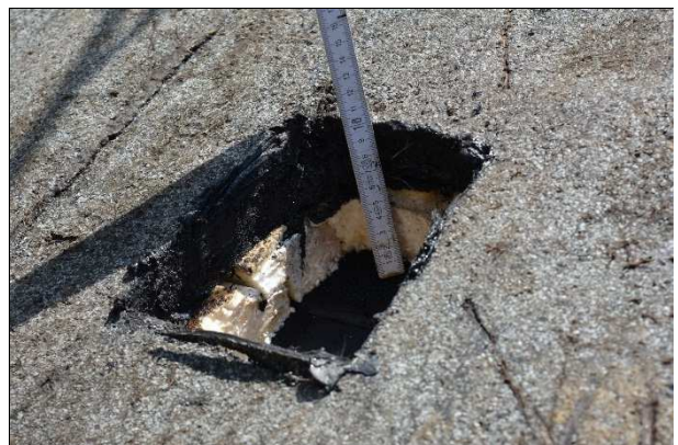
Bild 5 Die mehrfache Überklebung der Abdichtungsbahn hat im Laufe der etwa 40-jährigen Standzeit zu einer Schichtdicke von 5 cm Bitumenbahnen geführt.
