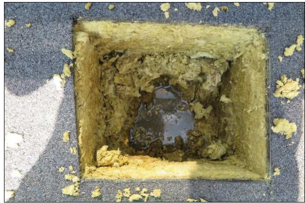
Bild 25 Stark durchfeuchtete Mineralwollgedämmung und Wasser auf der Dampfsperrbahn
