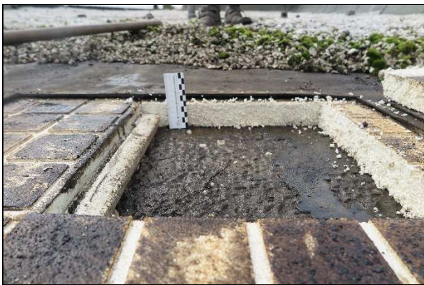
Bild 20 Öffnungsstelle 4 bei einer Dachfläche mit Zusatzdämmung aus EPS mit oberseitigen „Entspannungskanälen“. Die EPS-Dämmung war sehr stark feucht.
