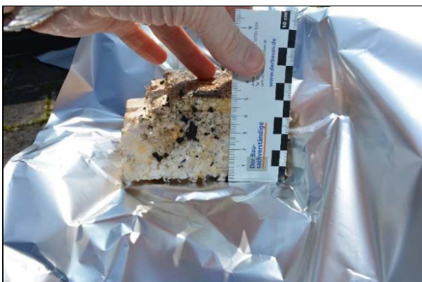
Bild 6 Zur Feuchtemessung entnommene Dämmstoffprobe.
