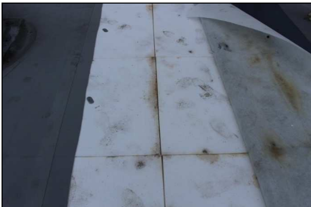
Bild 7 Feuchteintritte durch Hagelschaden haben nach ca. zwei Jahren zu Verfärbungen an den EPS-Dämmplatten geführt.
