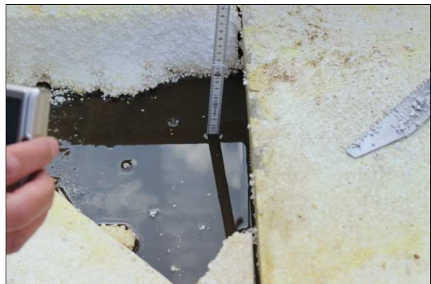
Bild 10 Nach der Entnahme der Dämmplatten nachsickerndes Wasser, das bis zu 1 cm hoch aufstaute.
