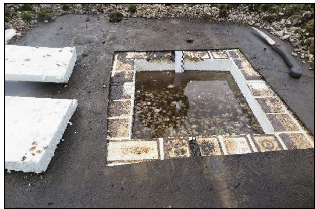
Bild 21 Öffnungsstelle 5 mit stark feuchter Zusatzdämmung und ca. 1 cm hohem Wasserstand auf der alten Abdichtung
