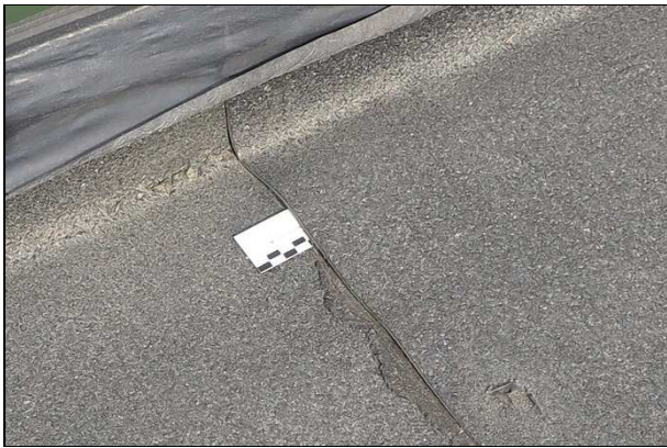
Bild 24 Offener Bahnenstoß bei Bitumenbahnabdichtung
