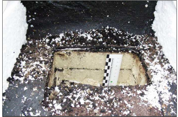
Bild 12 Öffnungsstelle am Anschluss einer Lichtkuppel mit gering durchfeuchteten PUR-Dämmstoffen
