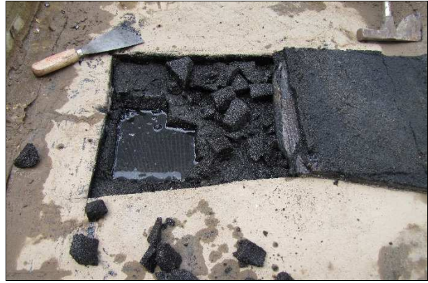
Bild 23 Öffnungsstelle mit Wasser in der Schaumglasschicht
