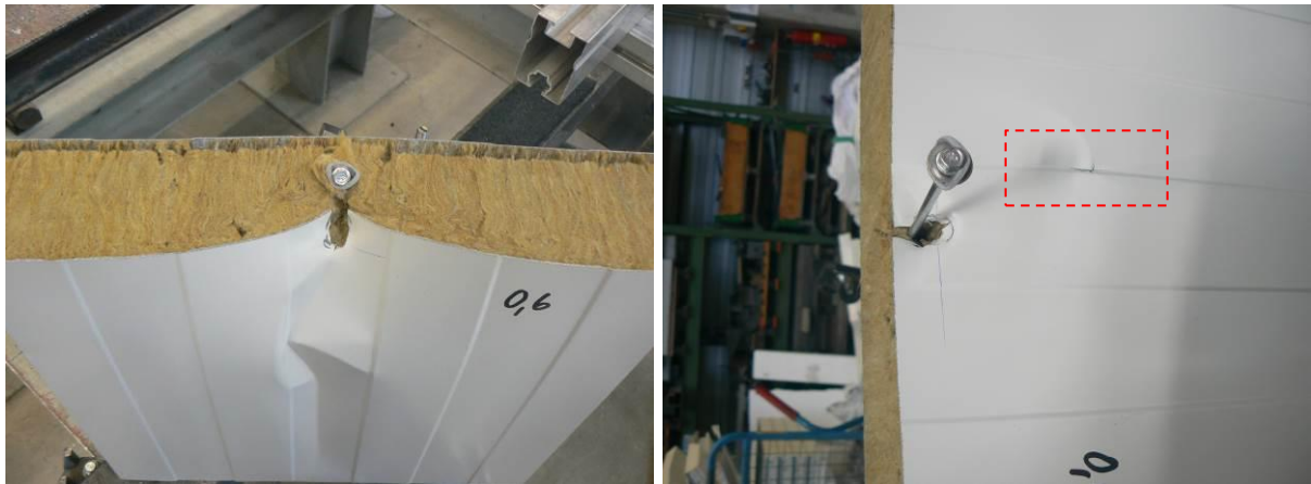
Bild 7.18: Knitterfalte im belasteten Deckblech (links), Riss am Sickensteg (rechts)
