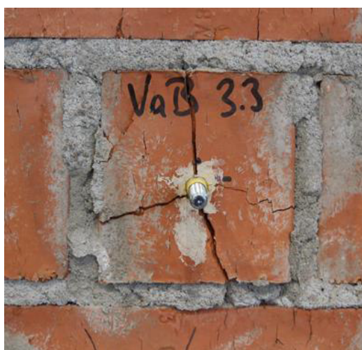
Abbildung 8-68: Versagensbild Bau Vollziegel – Mz-2DF, Binder – Test 3
