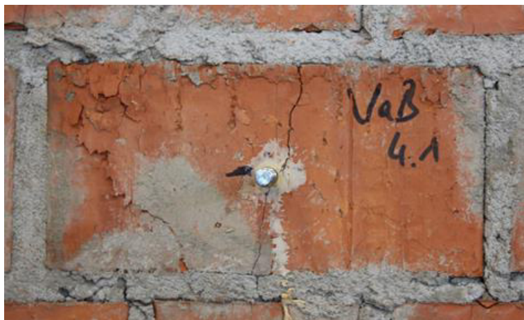
Abbildung 8-69: Versagensbild Bau Vollziegel – Mz-2DF, Läufer – Test 1
