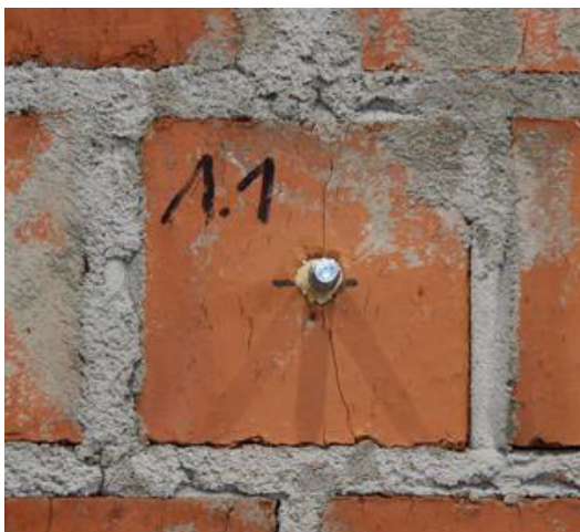
Abbildung 8-1: Versagensbild Ref Vollziegel – Mz-2DF, Binder – Test 1
