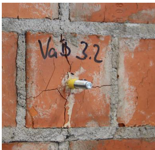
Abbildung 8-67: Versagensbild Bau Vollziegel – Mz-2DF, Binder – Test 2
