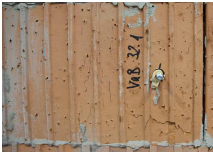
Abbildung 8-78: Versagensbild Bau PFZ-T24 – 1 Steg – Test 1
