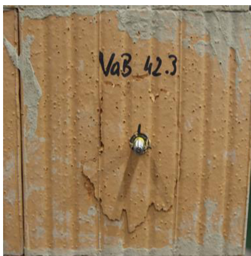
Abbildung 8-77: Versagensbild Bau T8 24 – 2 Stege – Test 3
