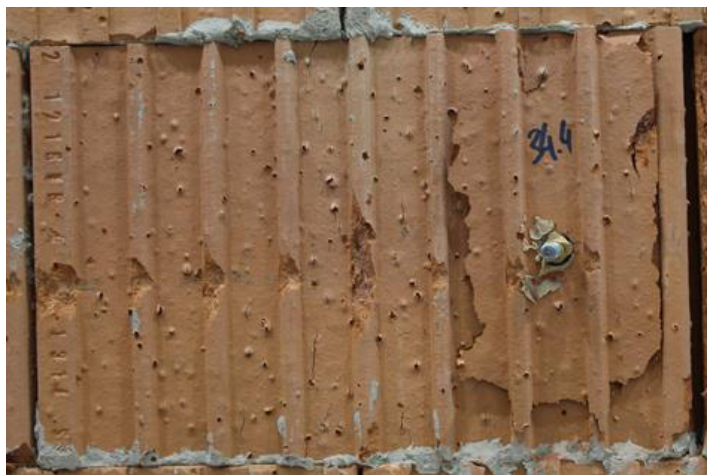
Abbildung 8-44: Versagensbild Stufentest PFZ T24 – 1 Steg Test 4
