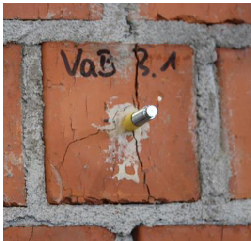
Abbildung 8-66: Versagensbild Bau Vollziegel – Mz-2DF, Binder – Test 1
