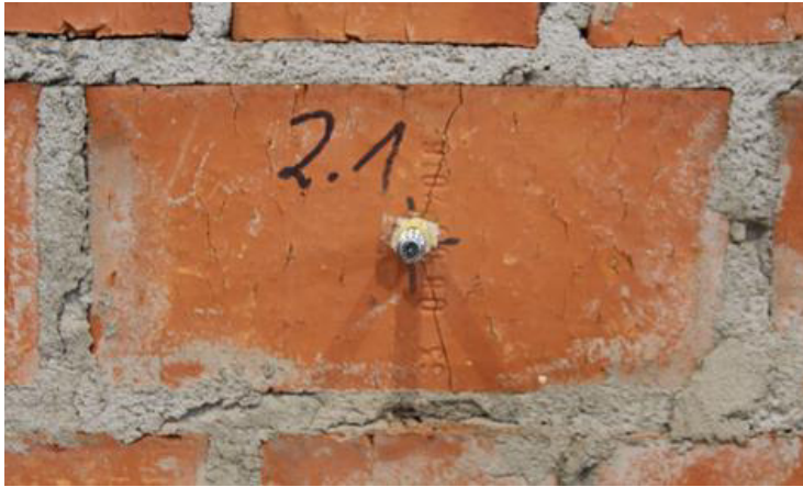
Abbildung 8-4: Versagensbild Ref Vollziegel – Mz-2DF, Läufer – Test 1
