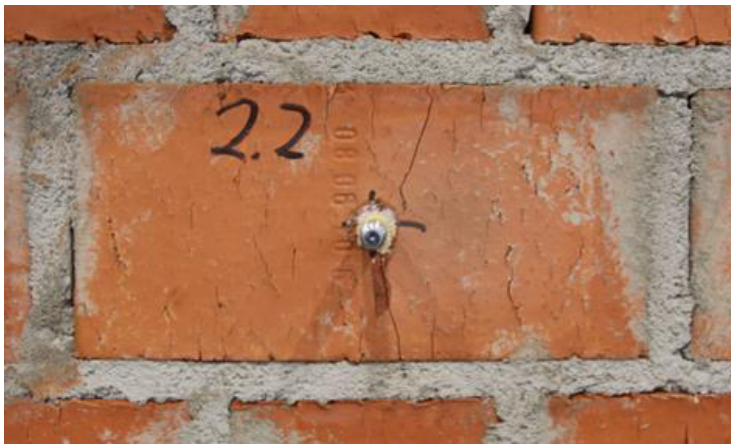
Abbildung 8-5: Versagensbild Ref Vollziegel – Mz-2DF, Läufer – Test 2
