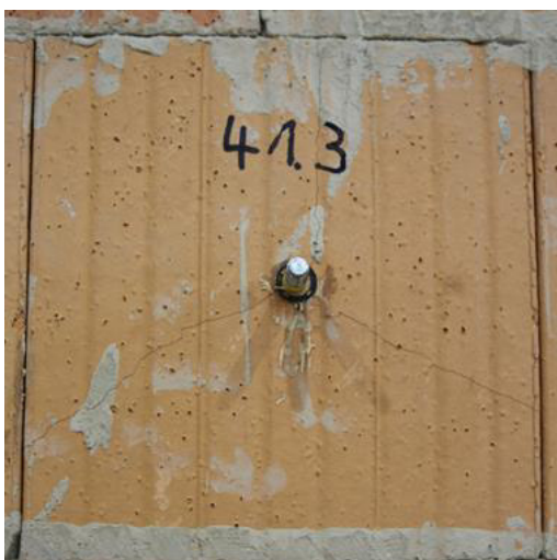
Abbildung 8-12: Versagensbild Ref T8 24 – 2 Stege – Test 3
